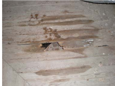
Figura 3.28. Degradación del pavimento de la capilla del extremo Sur del transepto.
