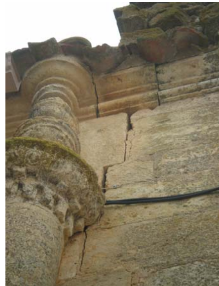
Figura 3.30. Grieta en la fachada Oeste.
