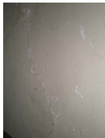
Figura 3.49. Fisura en el muro del primer tramo de escalera.
