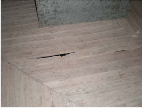
Figura 3.27. Degradación del pavimento de madera de la capilla del extremo Sur del transepto.
