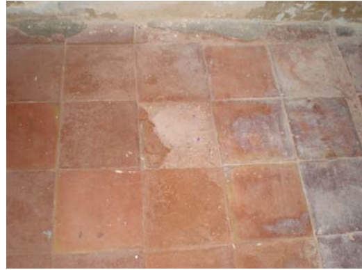
Figura 3.25. Erosión y disgregación del pavimento de baldosas de barro.
