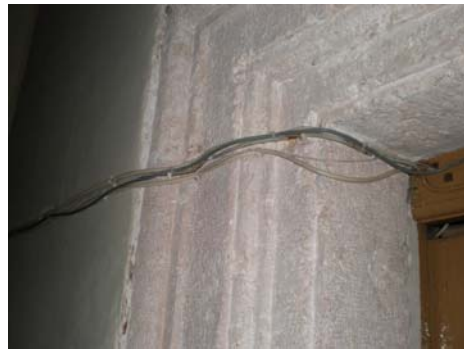
Figura 3.36. Cableado en el interior del edificio.
