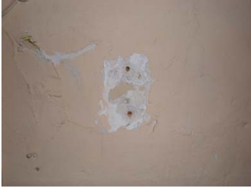
Figura 3.33. Perforaciones en el muro de la sacristía.
