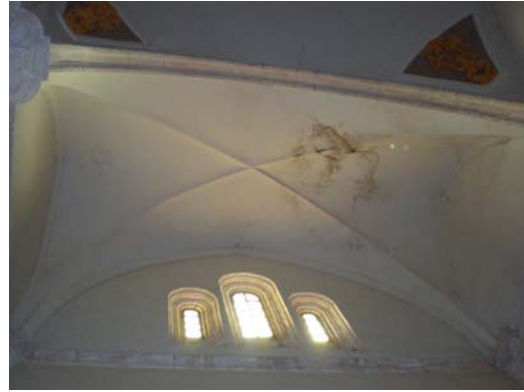
Figura 3.67. Manchas de humedad en la bóveda aristada del lado Sur del crucero.
