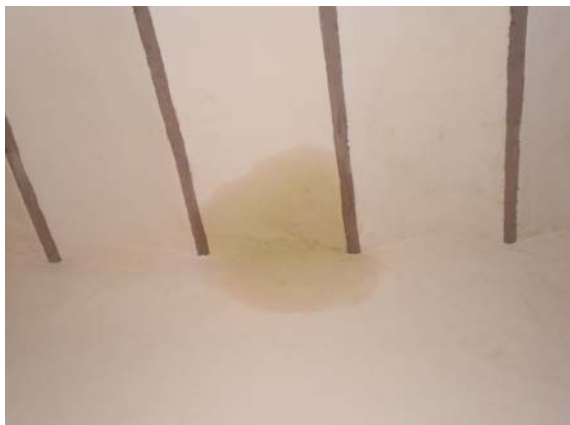
Figura 3.12. Mancha de humedad en el techo de la sacristía.
