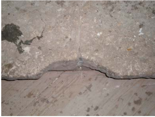
Figura 3.24. Erosión y disgregación del pavimento de baldosas pétreas.
