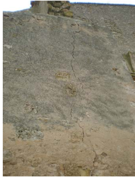
Figura 3.29. Fisura en la fachada Oeste.
