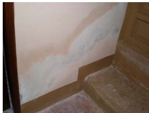
Figura 3.16. Eflorescencias en la sacristía.
