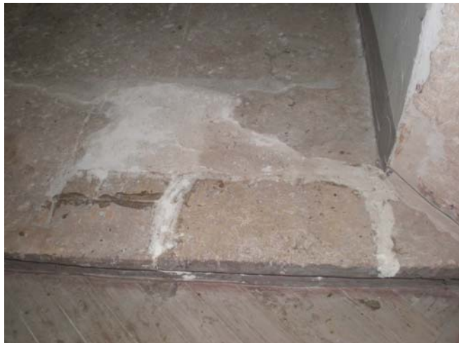
Figura 3.65. Rejuntados en el pavimento pétreo del ábside.
