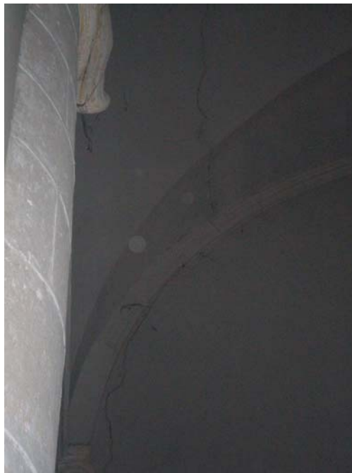
Figura 3.68. Fisuras en la bóveda de arista del lado Norte del crucero.
