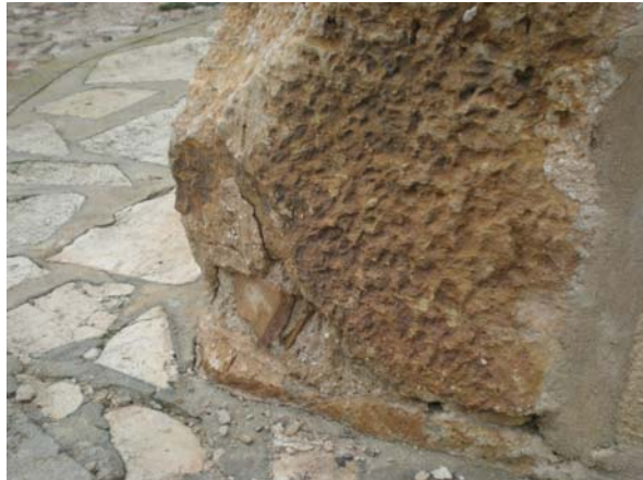
Figura 3.20. Erosión de la piedra en la esquina de la fachada Este con la Sur.
