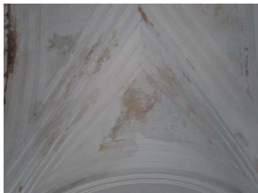
Figura 3.14. Humedad en la bóveda de cañón del extremo Sur del transepto.
