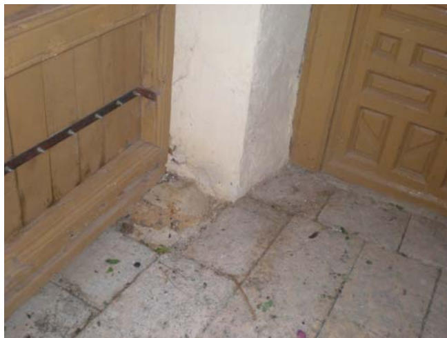
Figura 3.47. Erosión y disgregación en el pavimento pétreo de la zona de acceso.
