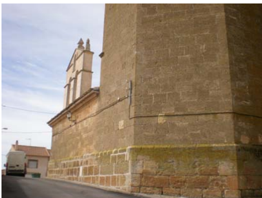
Figura 3.44. Patologías en la fachada Este.
