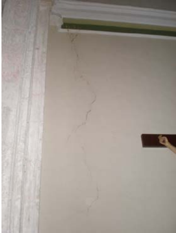
Figura 3.54. Fisura en el muro Este de la capilla del extremo Sur del transepto.
