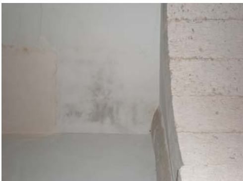
Figura 3.62. Ensuciamiento inorgánico en el techo de la zona de almacén.
