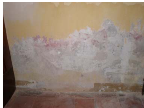
Figura 3.17. Criptoeflorescencias en la sacristía.
