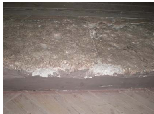
Figura 3.60. Erosión en el escalón de piedra para acceder a la capilla del extremo Norte del transepto.
