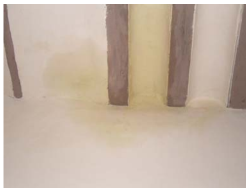
Figura 3.13. Humedad en el techo de la sacristía.
