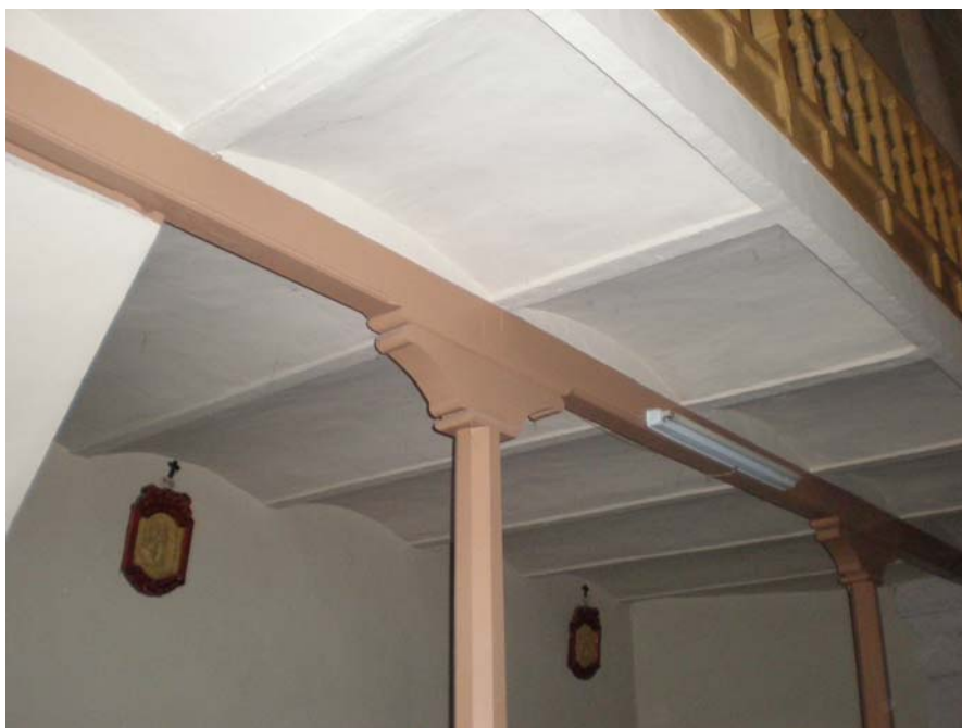
Figura 4.59. Forjado con revoltones, viga de madera, fuste y capitel de madera de los pilares, en el coro.
