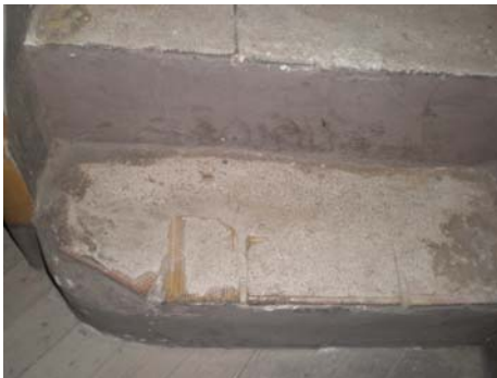
Figura 3.54. Erosión en la escalera de acceso al coro.
