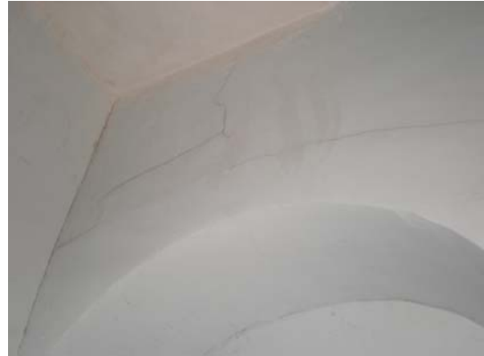
Figura 3.61. Fisuras encima del arco del muro Norte de la dependencia anexa al lado Norte del transepto.
