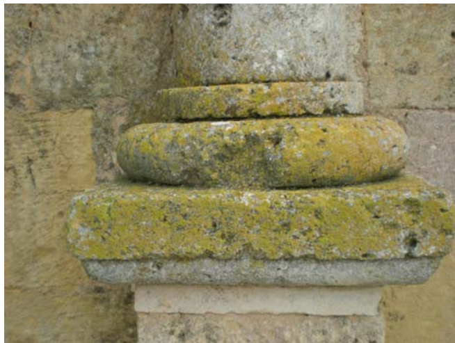
Figura 3.4. Ensuciamiento biológico en una de las columnas de la portada principal.
