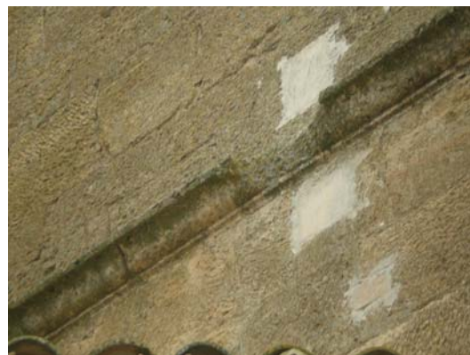
Figura 3.45. Disgregación en la fachada Este.
