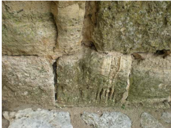
Figura 3.21. Erosión de la piedra en la fachada Este.
