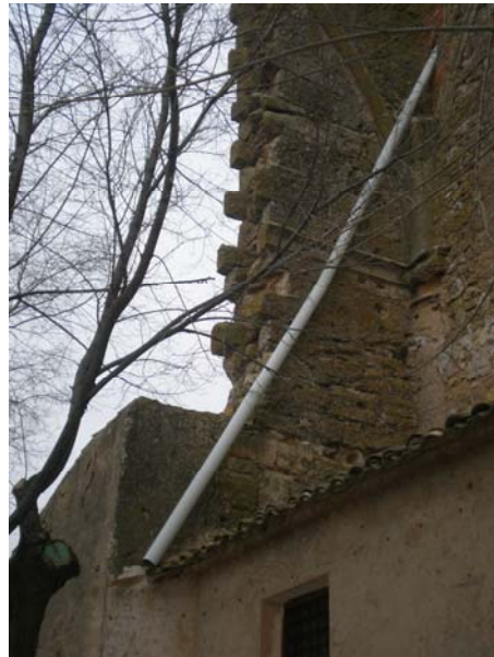
Figura 3.37. Canalón en la fachada Oeste.
