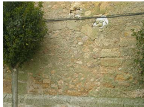
Figura 2.39. Arco de descarga en la fachada Sur.
