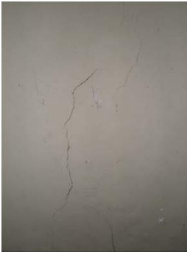
Figura 3.50. Fisura en el muro del segundo tramo de escalera.
