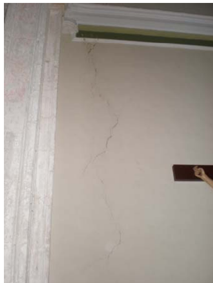
Figura 3.31. Fisura en la capilla del extremo Sur del transepto.
