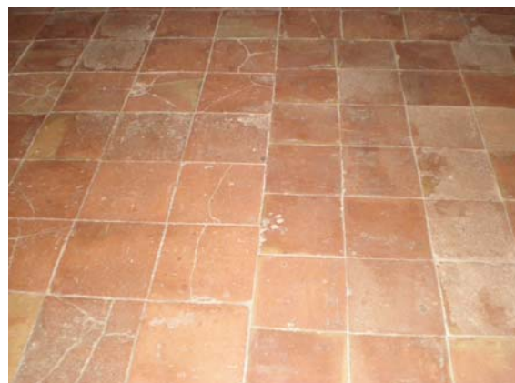
Figura 3.26. Fisuras en el pavimento de baldosas de barro.
