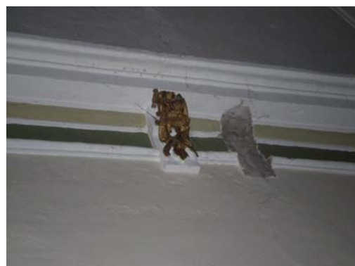
Figura 3.32. Pérdida de un elemento ornamental en la capilla del extremo Norte del transepto.
