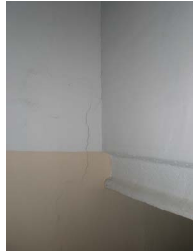
Figura 3.51. Fisura en la zona de unión entre la viga metálica y el muro.
