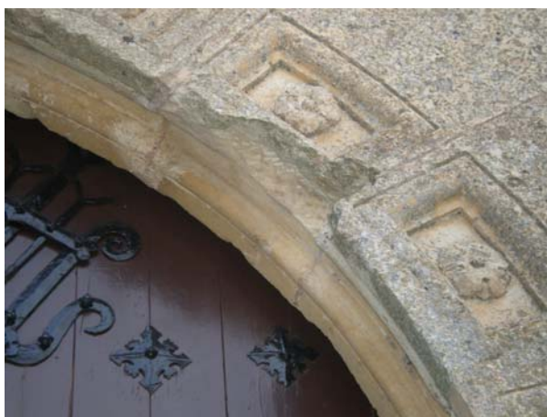
Figura 3.23. Disgregación en el arco de la portada principal.
