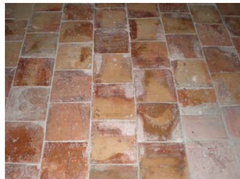
Figura 3.63. Erosión del pavimento de la dependencia anexa al lado Norte del transepto.
