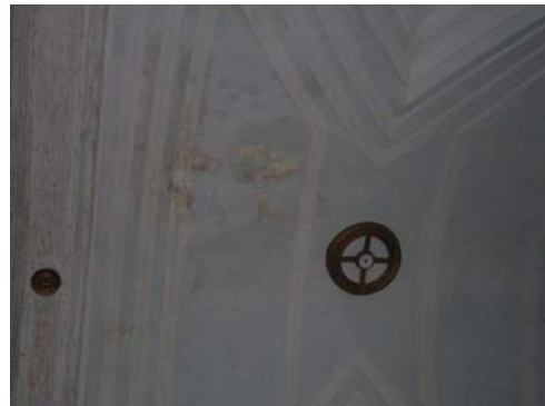
Figura 3.15. Eflorescencias en la bóveda de cañón del extremo Norte del transepto.
