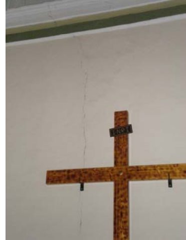
Figura 3.55. Fisura en el muro Oeste de la capilla del extremo Sur del transepto.
