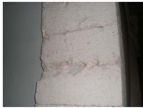
Figura 3.53. Erosión en el arco de medio punto del coro.
