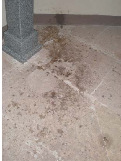
Figura 3.34. Mancha en el pavimento del ábside.
