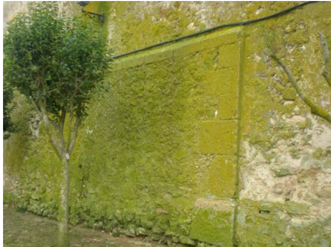
Figura 3.3. Ensuciamiento biológico en la fachada Norte.
