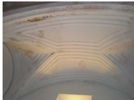
Figura 3.57. Manchas de humedad en el intradós de la bóveda de cañón de la capilla del extremo Sur del transepto.
