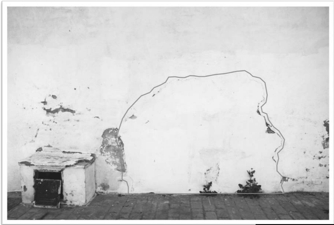
Fisura antigua entrada
