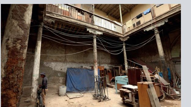
Interior de la misma casona de la imagen 80. Estado deplorable de la casona, obligando a vivir a los inquilinos en condiciones insalubres.
