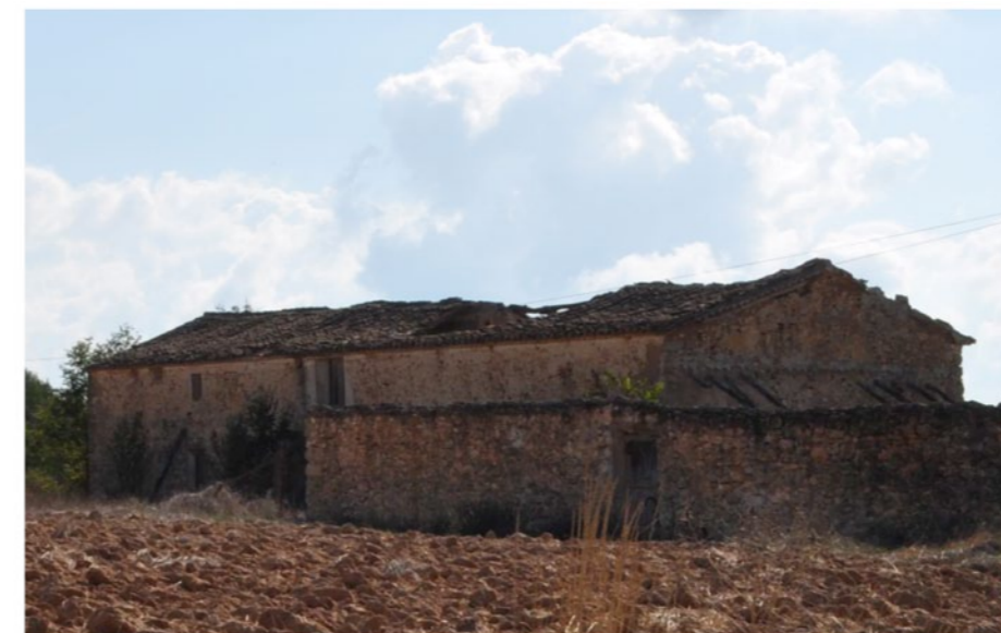
Vivienda semiderruida en los alrededores de La Portera.
