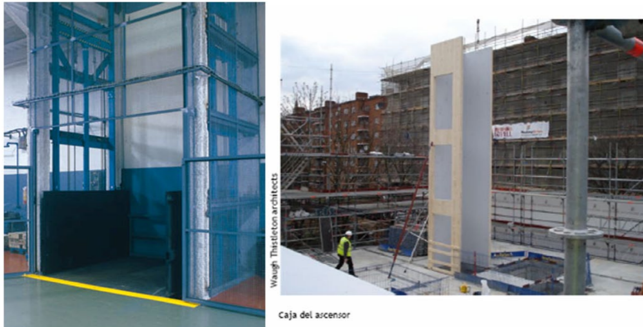
Detalles de montacargas (ENIER®) y caja de ascensor de madera contralaminada de un edificio en construcción en Murray Grove (Londres).
