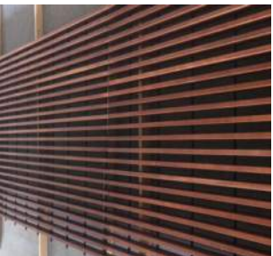
Falso techo metálico lineal Luxlón. Hunter Douglas (planta oficinas)
