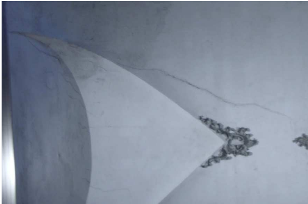
Fotografía 134. Fisuras en lunetos de la bóveda de cañón, sobre la nave.
