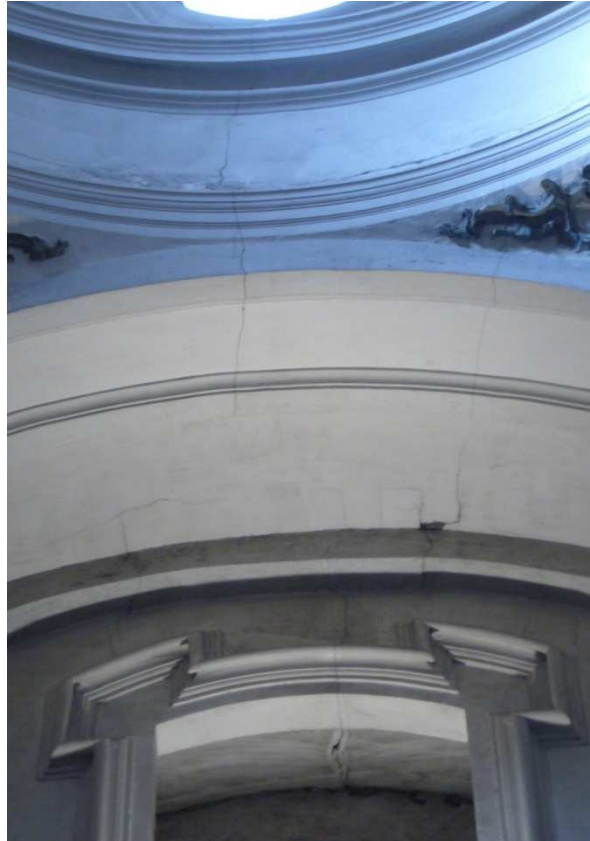
Fotografía 135. Fisuras brazo izquierdo falso crucero.
