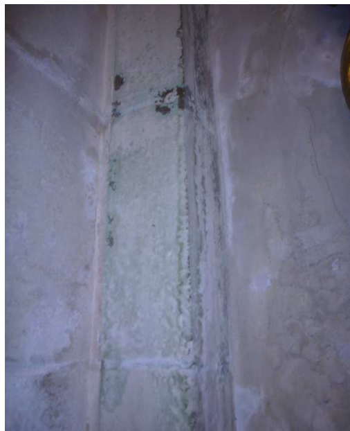
Fotografía 145. Mohos pilastra adosada al muro Norte, segunda capilla izquierda.
