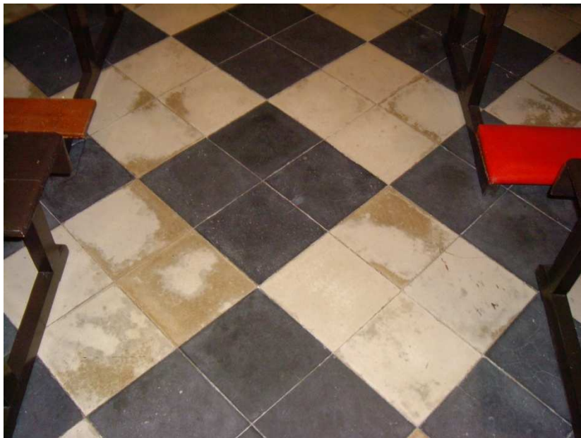
Fotografía 133. Manchas en el pavimento.
