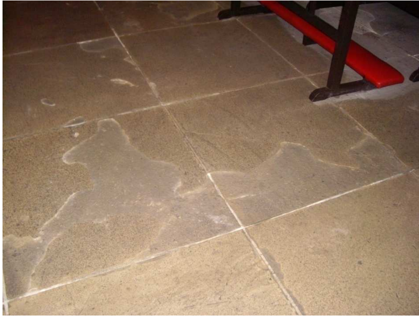
Fotografía 35. Estado actual del pavimento de la nave central.
