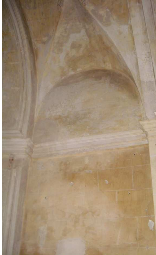
Fotografía 139. Decoloraciones en paredes y techo, segunda capilla lado derecho.
