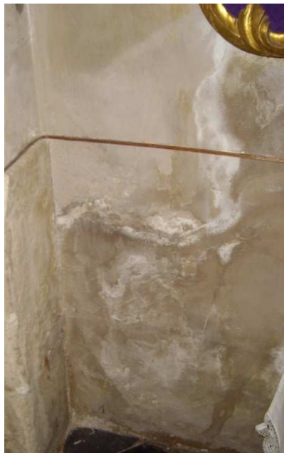
Fotografía 141. Eflorescencias, segunda capilla lateral izquierdo.
