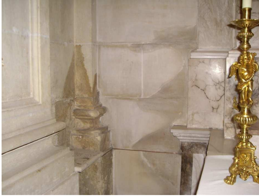
Fotografía 132. Manchas de humedad, brazo izquierdo del falso crucero.
