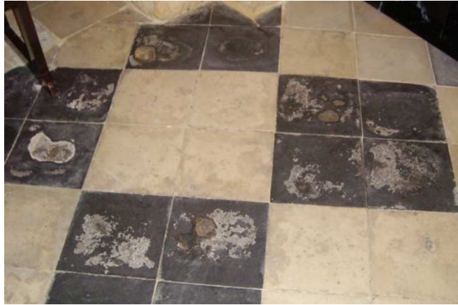
Fotografía 144. Pérdida de material en pavimento.
