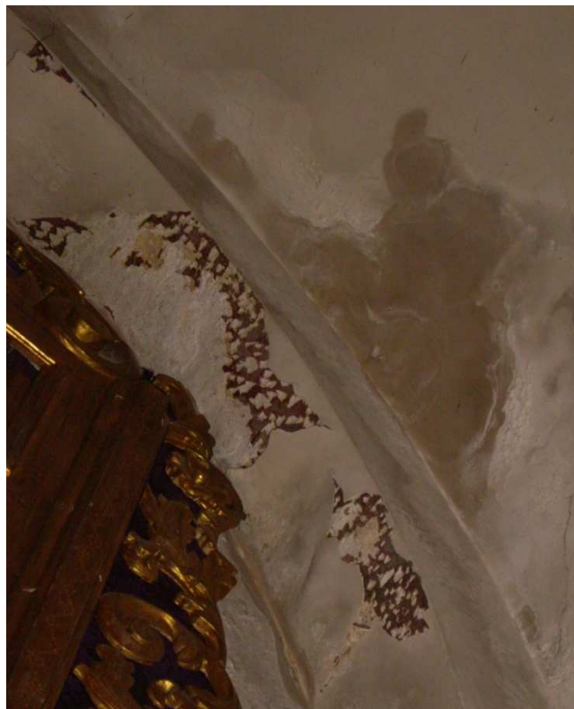
Fotografía 138. Desconchado de enlucido, capilla segunda del lado izquierdo.
