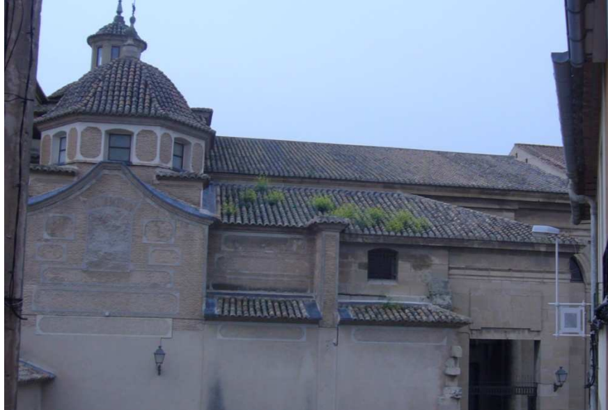
Fotografía 146. Vegetación sobre cubierta.
