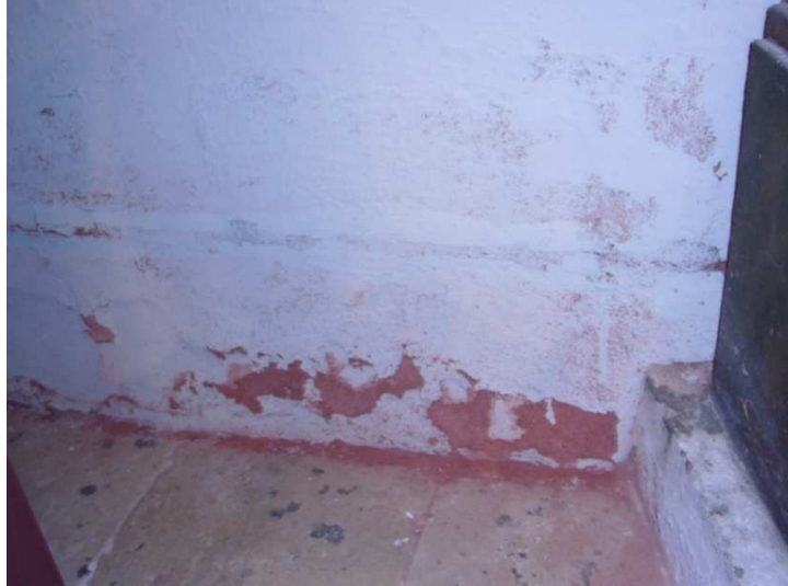
Fotografía 137. Desconchado de pintura junto a retablo del altar.
