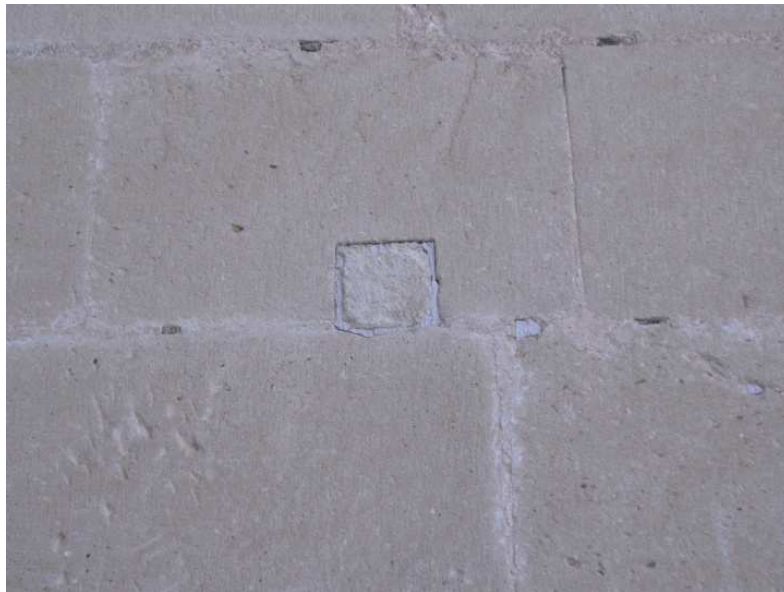
Fotografía 62. Mechinal cegado en muro neoclásico Norte.
