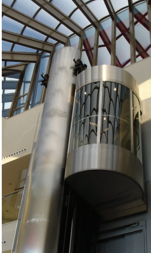
6 Ascensor edificio corporativo
