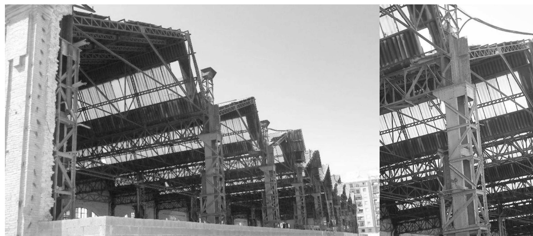
Imágenes de la estructura de la nave en el estado actual, Archivo municipal del Ayunt. de Valencia
