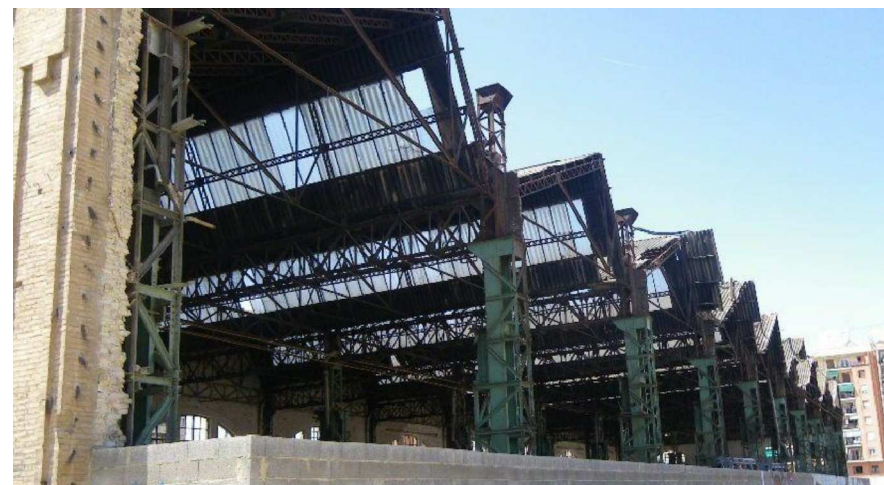
Imagen de la fachada este (demolido) y la estructura de hierro, estado actual, archivo municipal.
