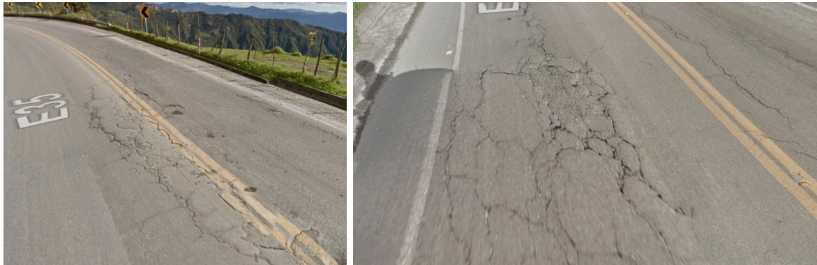
Figura 44. Ejemplo de correcciones a realizar respecto al estado del pavimento.
