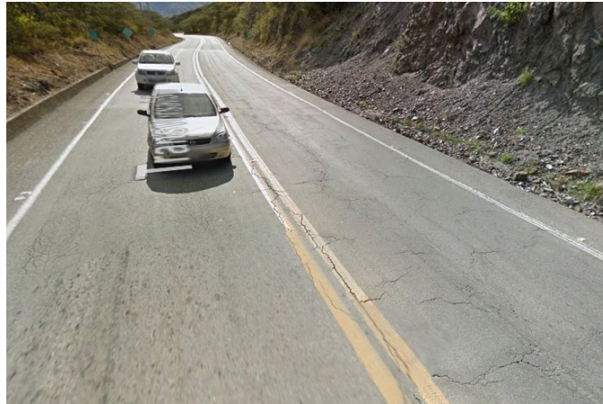
Figura 35. Estado del pavimento en el tramo 4
