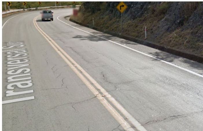
Figura 36. Estado del pavimento en el tramo 5
