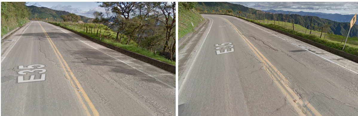
Figura 32. Estado del pavimento en el tramo 1
