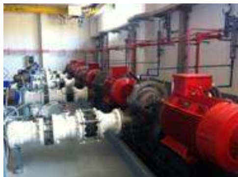
Figura 9: Bombas de agua de mar (o bruta).
