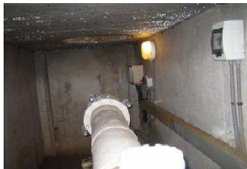
Figura 8: Pozo de captación.
