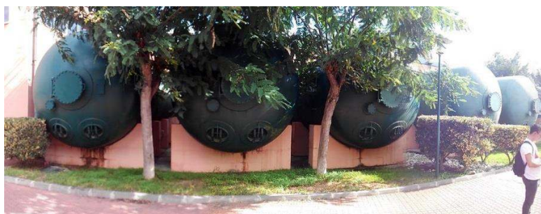
Figura 10: Filtros de arena.
