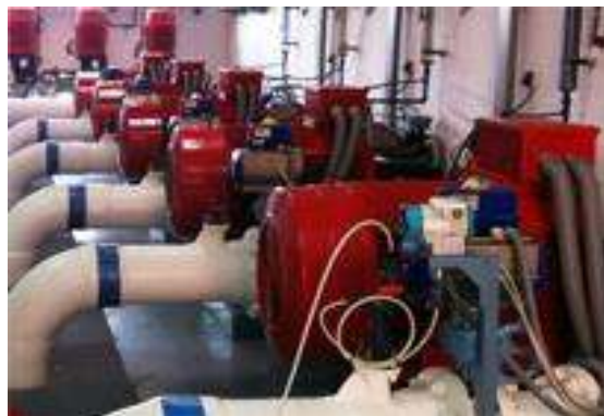
Figura 14: Bombas de agua tratada.
