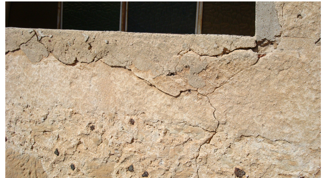
Detalle de fisuras en las ventanas de la fachada derecha.
