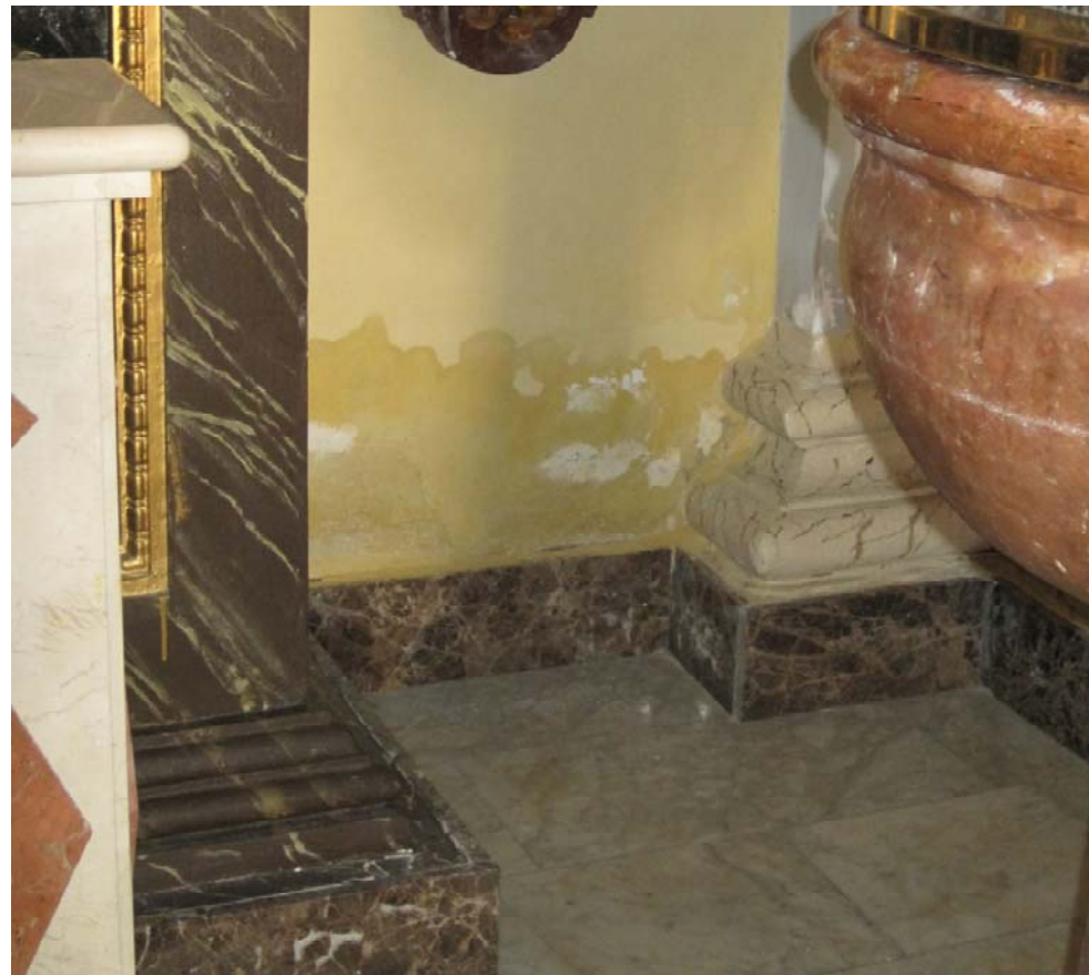
Ejemplo de una de las muchas manchas de humedad por capilaridad.
