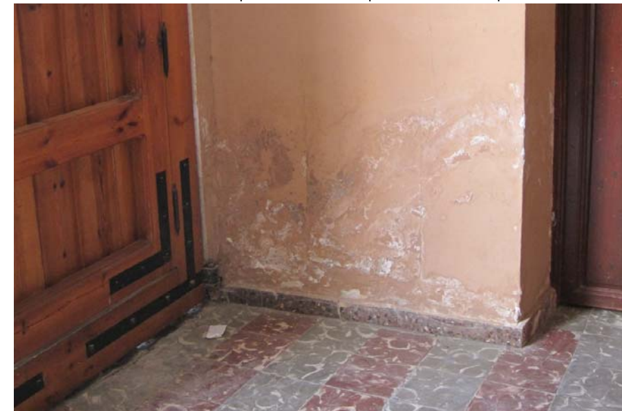
Eflorescencias en la entrada principal debidas a las humedades por capilaridad
