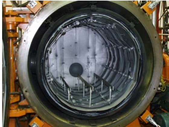
Figura I. 6 Interior de un horno de Sinterizado.
