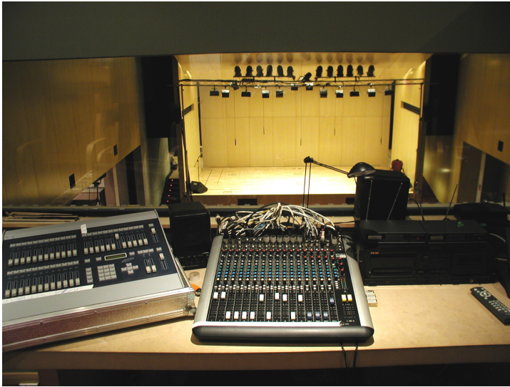
Fig.1.9. Interior cabina de control. Mesa de sonido.
