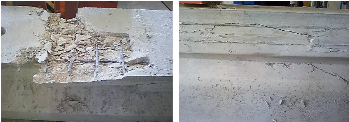
Figura 4.27. Comparación segunda fase de ensayo. Viga 1 vs. Viga 2.
