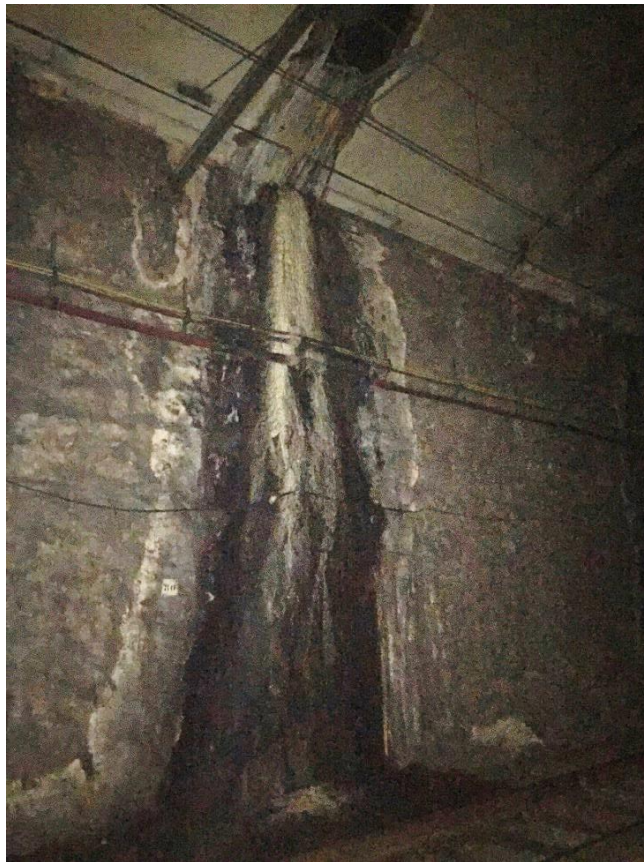
Fig. 137 Entrada de agua por hastial II. Fuente: Elaboración propia
