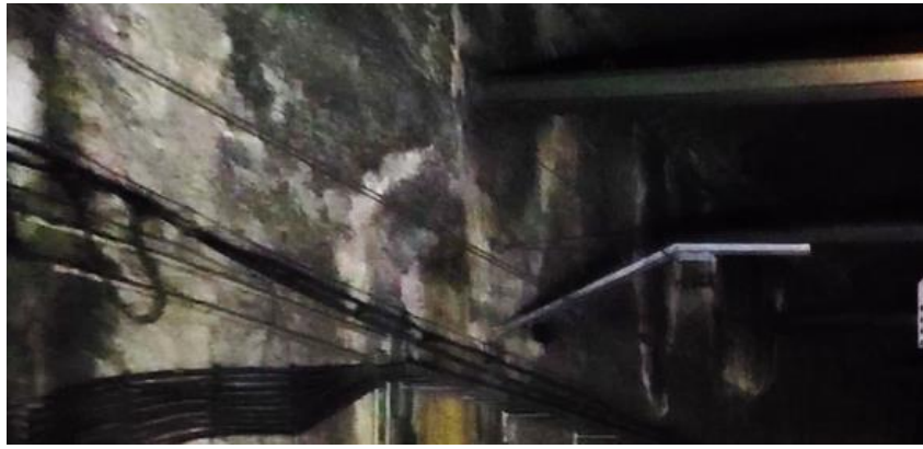
Fig. 141 Ejemplo estampadores metálicos con afloramiento hídrico. Fuente: Elaboración propia
