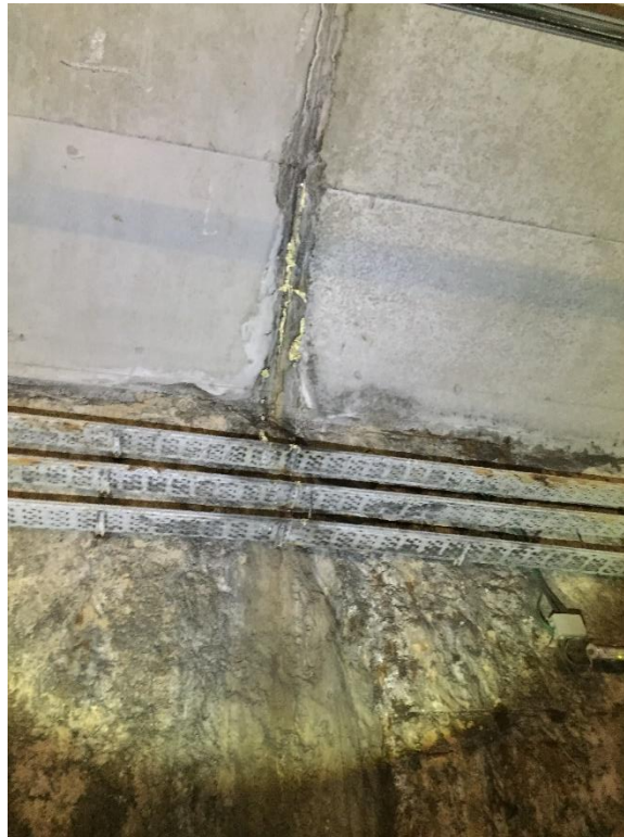
Fig. 143 Junta abierta tratada con producto expansivo en la bóveda superior. Fuente: Elaboración propia
