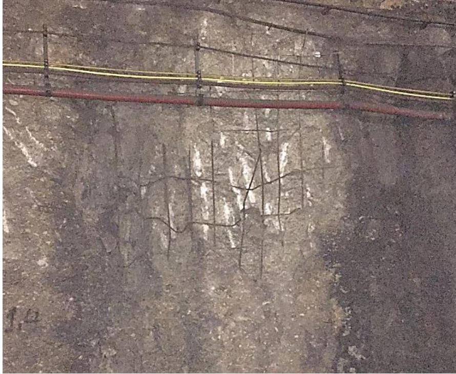
Fig. 140. Ejemplo armaduras vistas en hastial. Fuente: Elaboración propia
