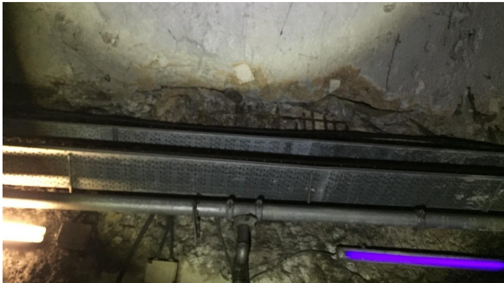
Fig. 142 Ejemplo de desconchón en la unión hastial - bóveda. Fuente: Elaboración propia
