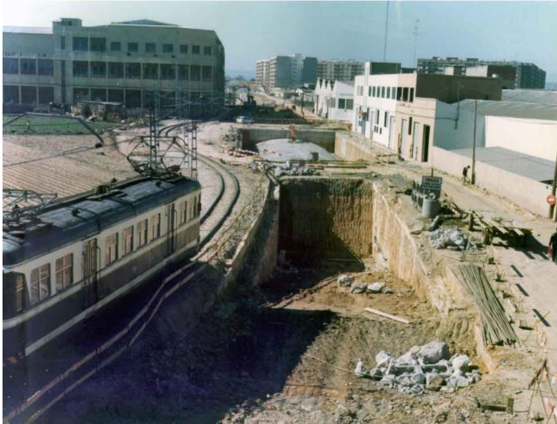
Fig. 5 Obras de soterramiento de la traza del metro en la estación de Safranar. Fuente: www.metrovalencia.es
