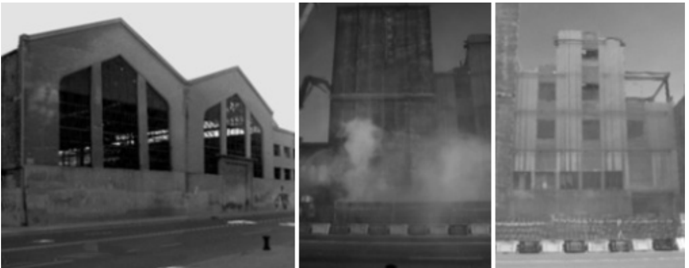
Figura 1. Naves de Macosa y demolición Cervezas el Turia. Calle San Vicente. Valencia. María Zárraga. 2008.
