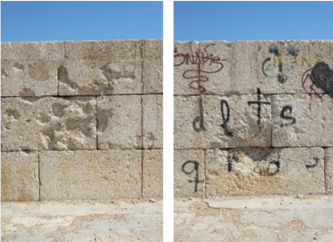
Figura 5. Impactos de metralla en muro del puerto de Vinaroz. María Zarraga. 2014.
