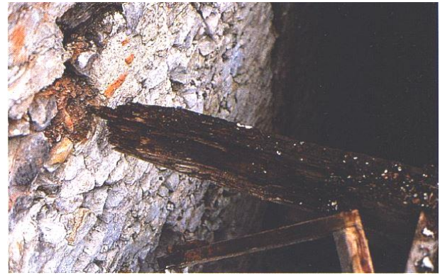
Figura 4.47_ Viga con alto nivel de deterioro por la acción de la humedad.
