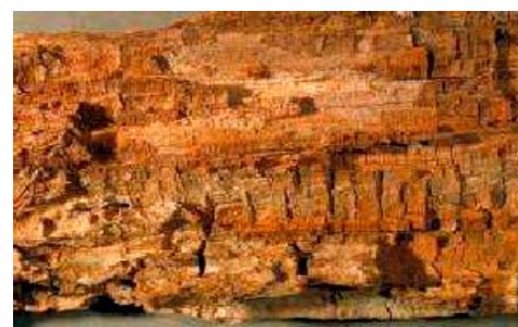
Figura 3.24_ Pudrición parda (viga afectada y detalle).
