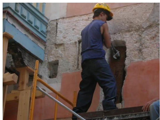
Figura 4.15_ Colocación de los tensores arriostrando la fachada. Dos por cada arco de medio punto, 2009.
