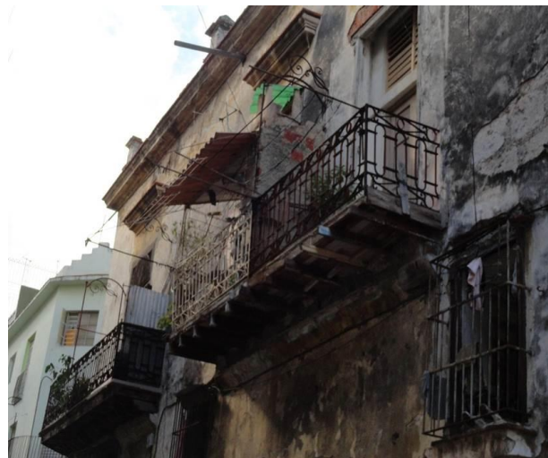
Figura 3.30_ Fachada de la Calle Lamparilla esquina a Habana. Deterioro avanzado, múltiples lesiones, pero aun sin riesgo de fallo estructural.
