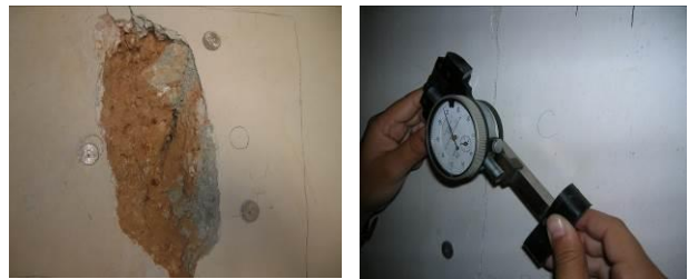
Figura 4.16_ Mediciones de las grietas en el muro de fachada que da a la calle Aguiar, 2009.
