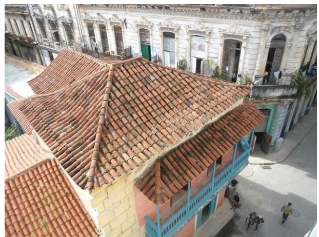
Figuras 4.24 | 4.25 y 4.26 Estado actual de las cubiertas de la Casa Prat Puig
