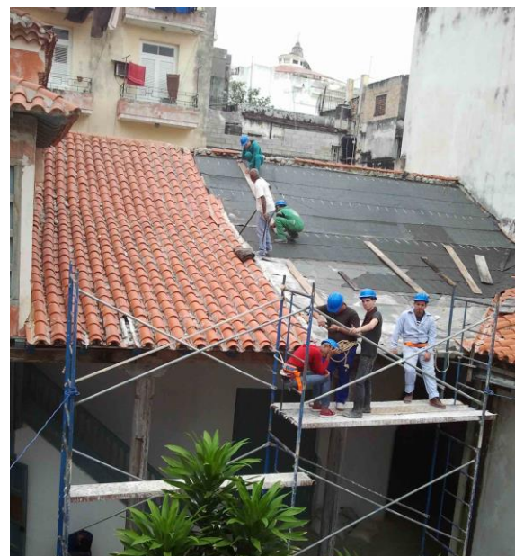
Figura 4.60_ Sustitución de tejas criolla en el faldón de la galería anterior. Casa Prat Puig, 2014.
