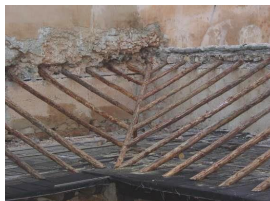
Figura 4.12_ Intervención desacertada en los faldones de las galerías y el ala este de la Casa Prat Puig durante la restauración, año 2005.
