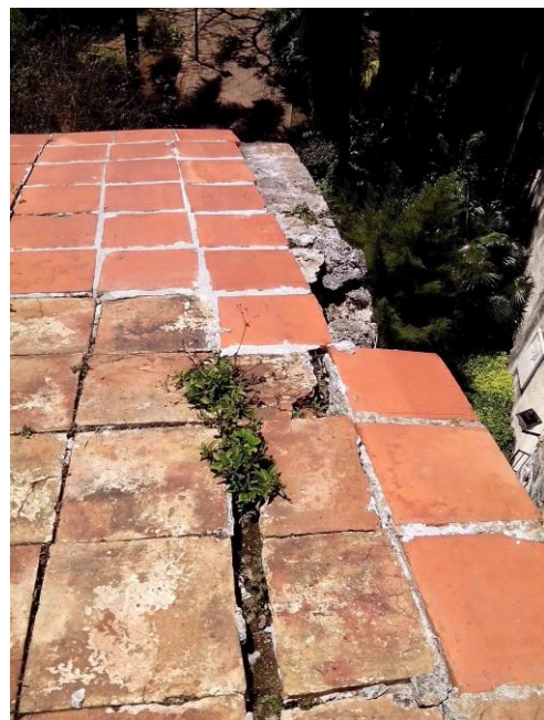
Figura 3.32 (arriba)_ Deterioros en cobertura de losas de barro en cubierta plana del edificio de Obrapia No. 510.
