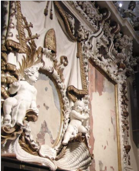
Fig. 3. Capilla de San Pedro de la catedral de Valencia. Frescos restaurados de la pared izquierda
