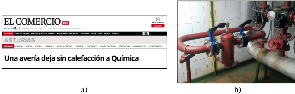
Fig. 3 Noticia que apareció el primer día de clase en la Fac. de Químicas y reparación realizada.
