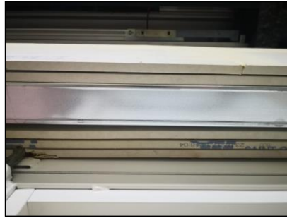
Figura 28. Blindaje con Placo® X-Ray Protection en la sala de ensayos.
