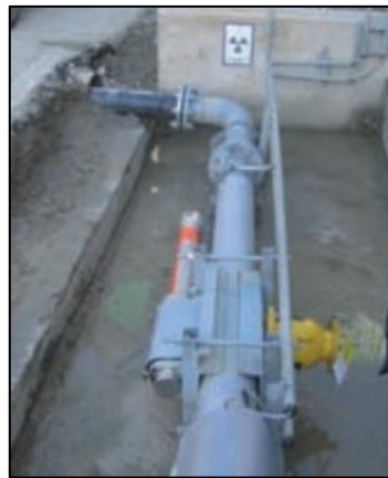
Figura 8. Equipo de control de proceso para medida de llenado (CSN, 2015).
