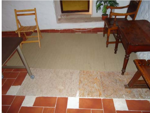
Pérdida de pavimento en planta baja
