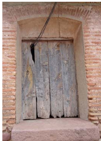
Carpintería sin restaurar
