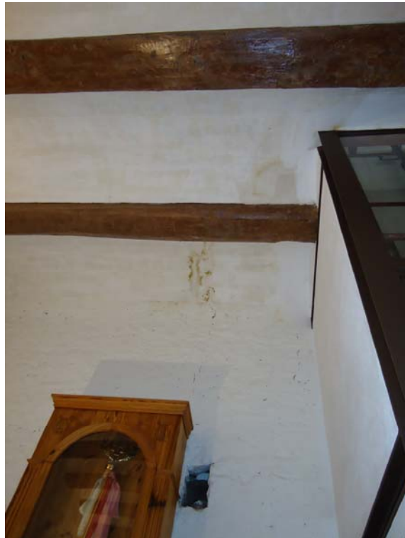
Humedad en paramento
