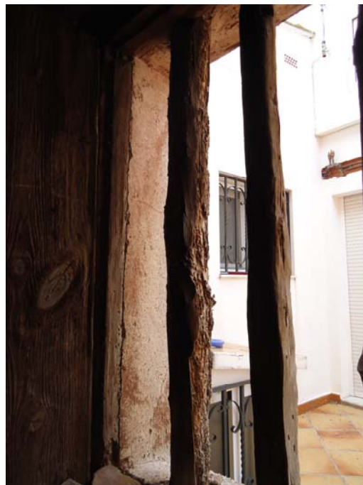
Carpintería afectada por hongos y termitas
