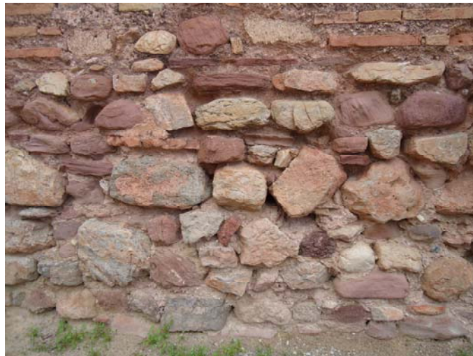
Perdida de mortero de cal en paramento exterior
