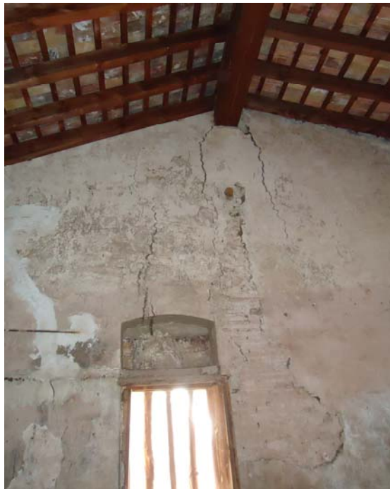
Grietas y fisuras en paramento
