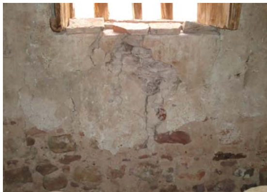
Desprendimiento en revestimiento de muro
