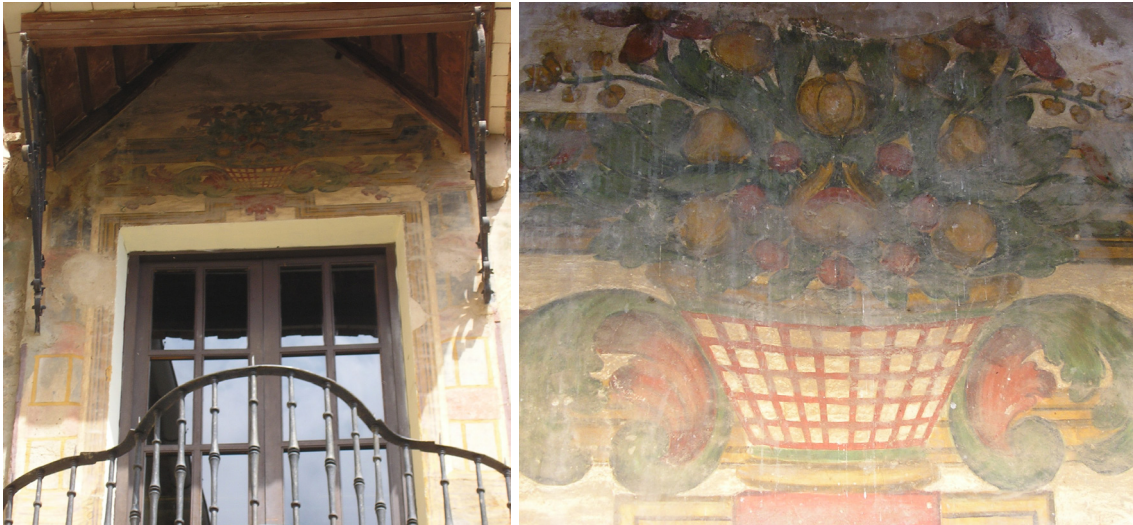
Figuras 73 y 74: Zona intervenida y detalle de la superficie antes del tratamiento de restauración.
