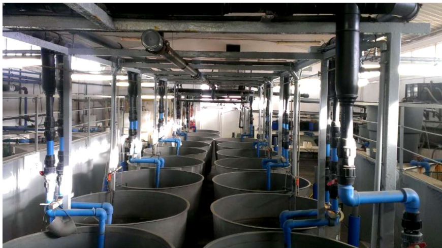
Figura 8. Distribución de los tanques de la línea 2 en el LAC
