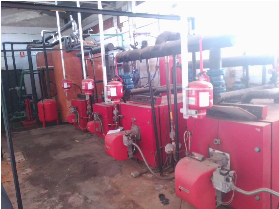
Figura 1.3-1- Sala de Calderas Actual
