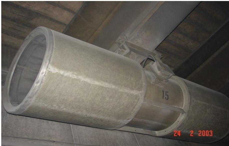
Imagen 3.13. Ventilador longitudinal utilizado.
