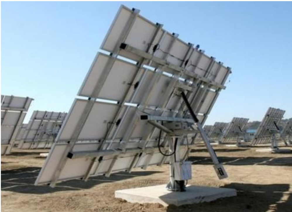
Imagen 7.5. Soporte con seguidor solar para placas solares.
