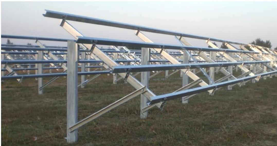
Imagen 7.6. Soportes fijos para placas solares.
