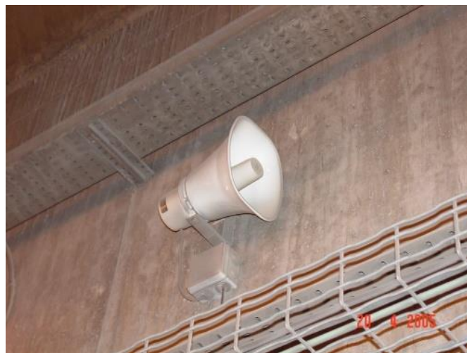
Imagen 2.3. Sistema de megafonía.
