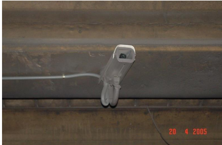
Imagen 3.5. Sistema de vigilancia del túnel.
