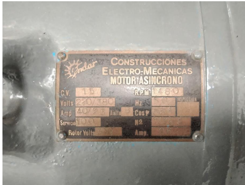
Fig. 28 Placa de Características del Motor Ensayado
