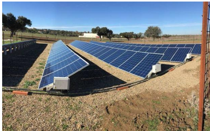
Ilustración 5. Módulos solares fotovoltaicos
