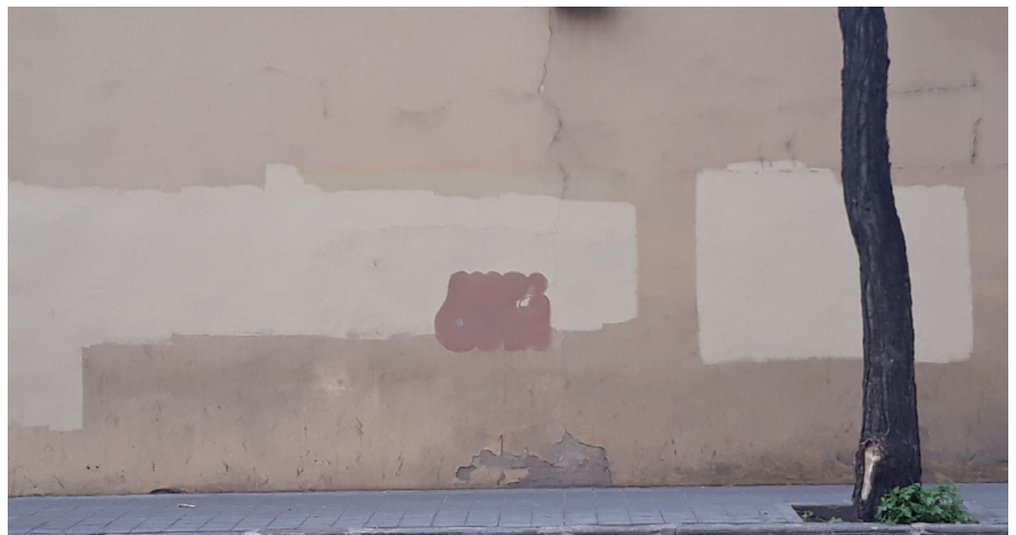
Graffiti removal en una pared de Valencia (fotografía Cris Bartual).
