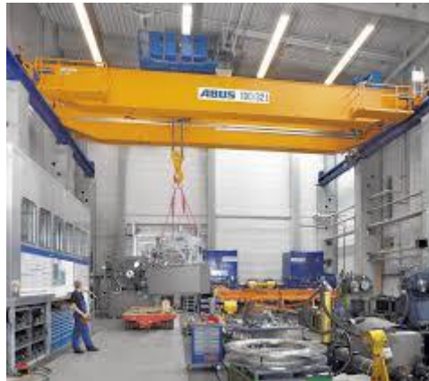
Figura 31: Puente grúa birrail
