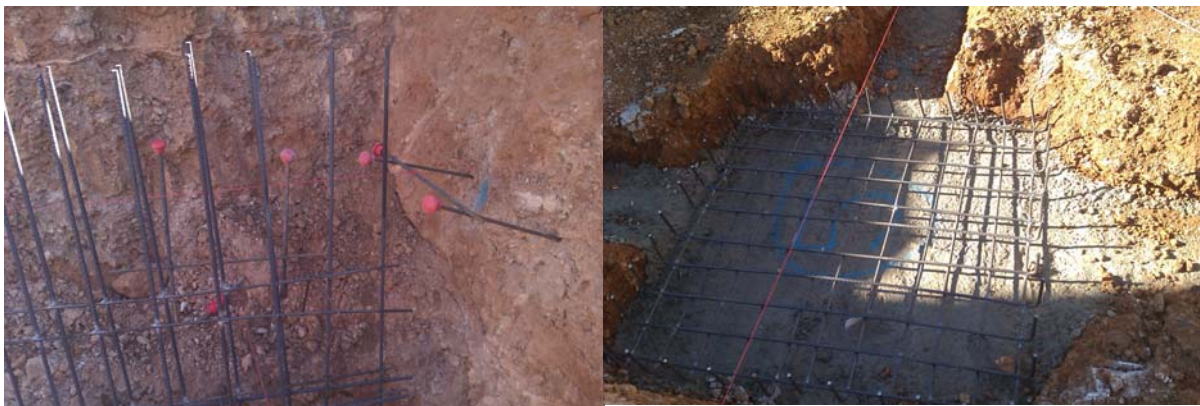
(Foto 1). Colocación de la líneas de los pilares. (Foto 2). Colocación de armado de zapatas.
