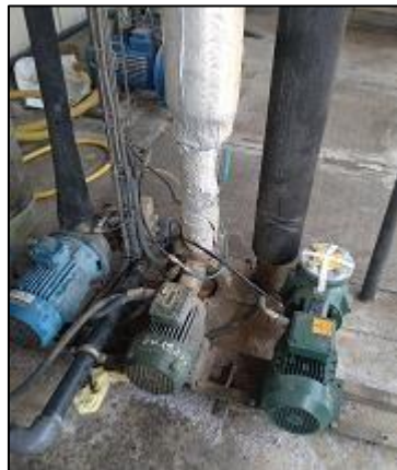
Figura 14. Bombas de impulsión.
