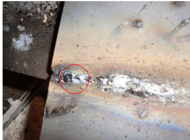
Porosidad por humedad
