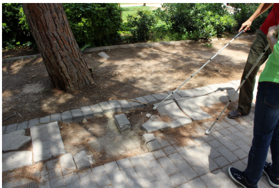
Imatge 6. Paviment en mal estat de manteniment al tram I del parc Túria.
