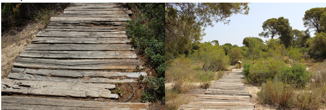
Imatges 26 i 27. Travesses de tren desgastades i trencades de l'itinerari.
