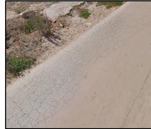
Figura 3: Desperfectos tramo existente
