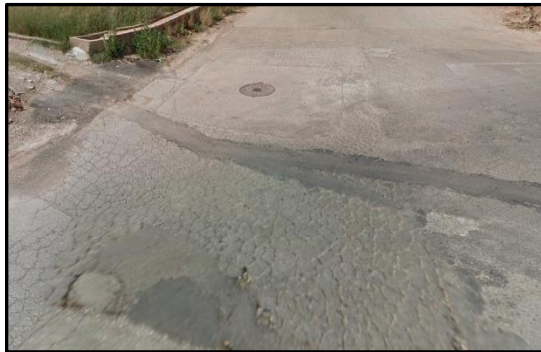
Figura 2: Desperfectos tramo existente
