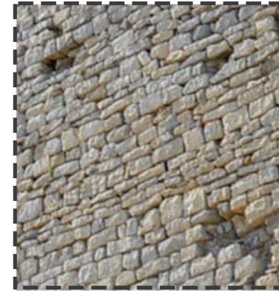
2. Pérdida de piezas
