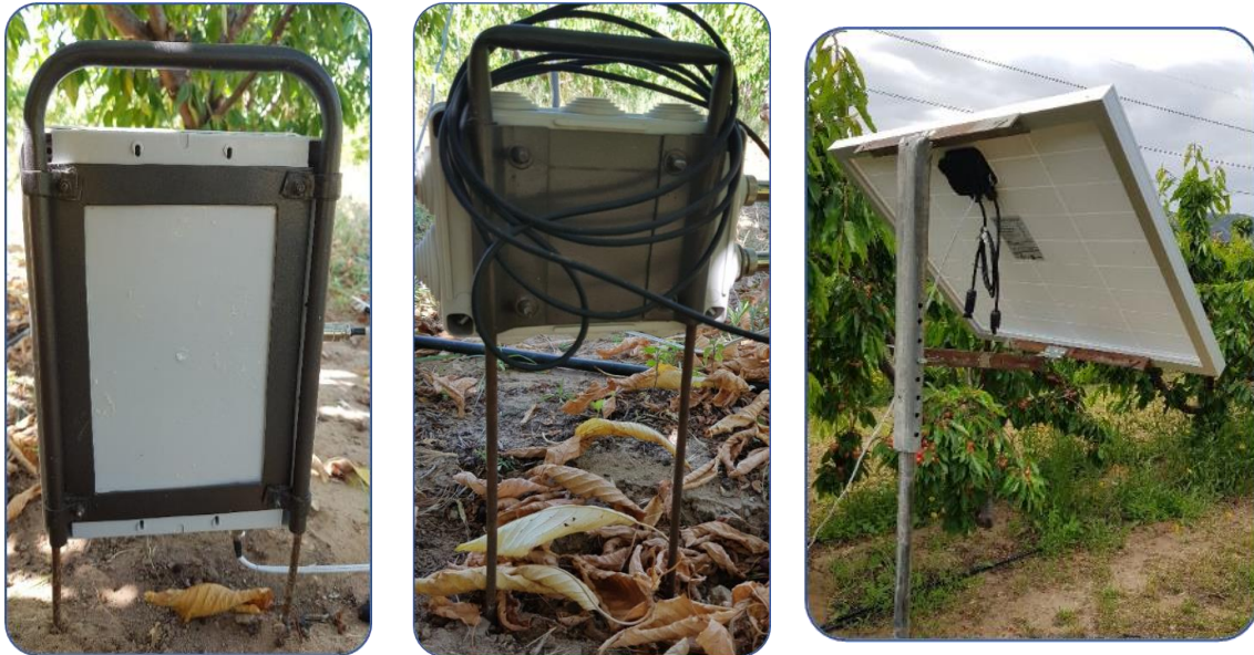
Figura 4. Soportes diseñados, fabricados e instalados en las cajas de los equipos y en el módulo solar. Fuente: elaboración propia.
