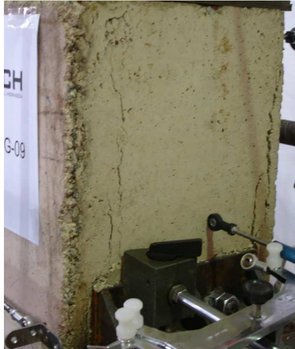
Fig. 3.36. Penetración del capitel a compresión y aparición de fisuras marcando el recubrimiento, en las probetas RC-L2
