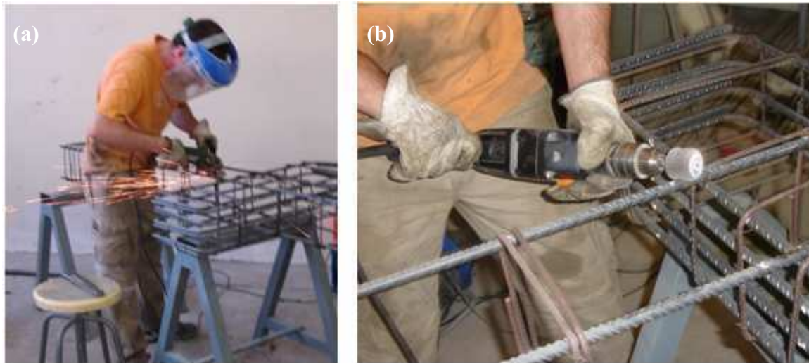
Fig. II.1. Preparación de la ferralla para la disposición de galgas. (a) Eliminación de la corruga con radial; (b) Lijado
