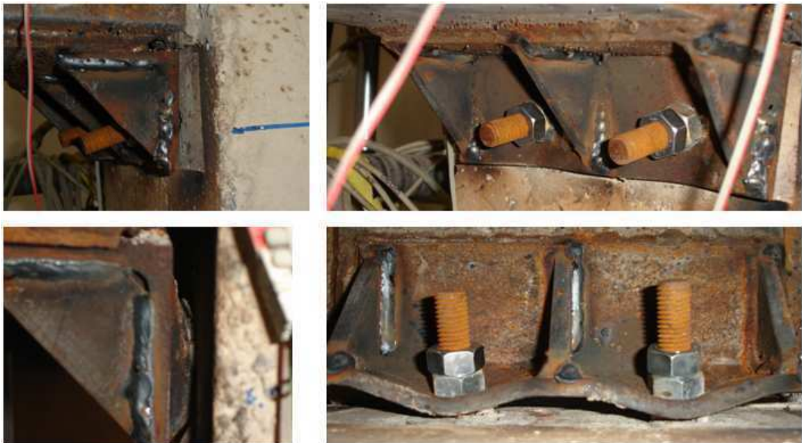
Fig. 3.45. Diversas vistas del estado en que quedaban los capiteles en tracción en las probetas B-L1 tras se ensayadas
