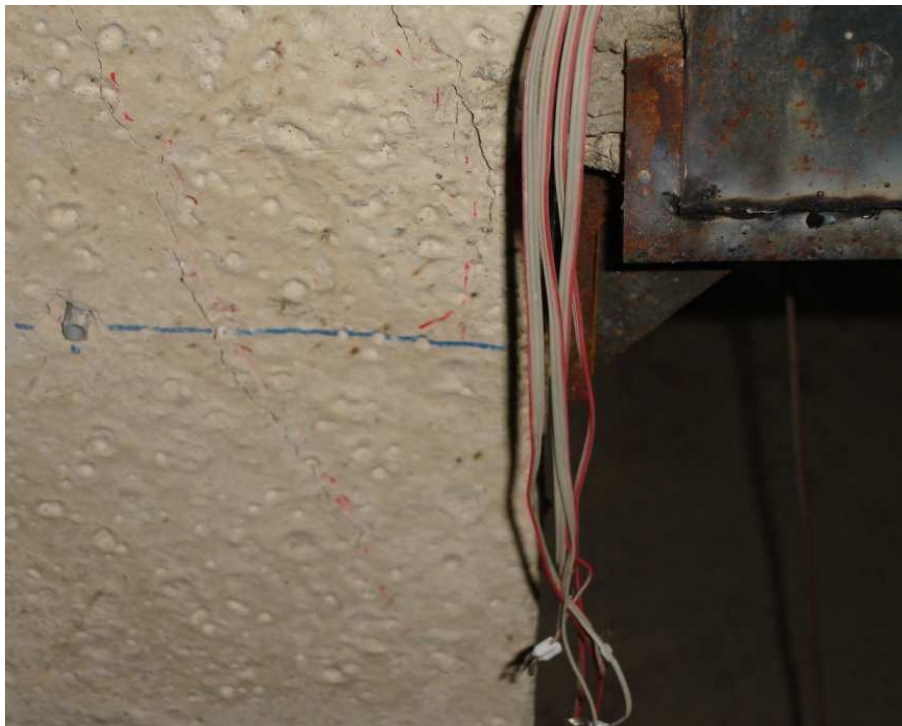
Fig. 3.33. Fisuración aparecida en la cara de tracción en las probetas RC-L2
