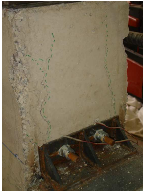
Fig. 3.47. Fisuración inducida en el tramo de viga, marcando el recubrimiento del hormigón, por la penetración de los capiteles en compresión en las probetas B-L1
