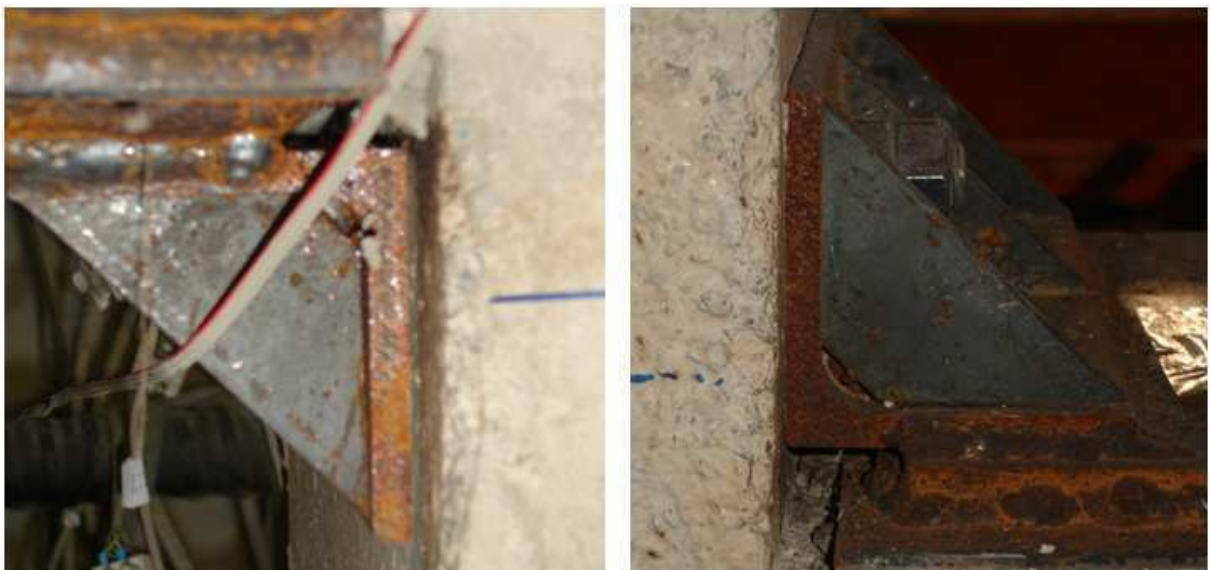
Fig. 3.31. Estado de los capiteles tras el ensayo en las probetas RC-L1. (a) Capitel en cara de tracción (pequeño despegue); (b) Capitel en cara de compresión (penetración)
