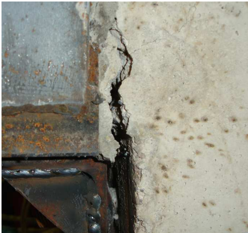
Fig. 3.44. Fisura de tracción aparecida en el entronque del soporte con el nudo, en las probetas B-L1
