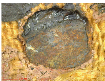
Figura 10. Sistema de tensado mediante clavos (cabeza de clavo oxidado).
