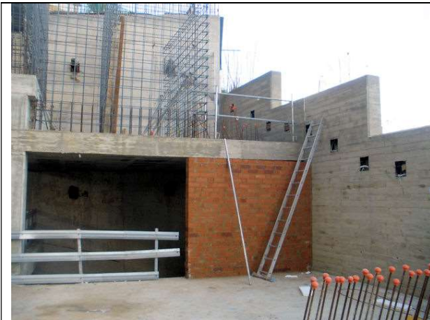
Muros de carga de ladrillo panal de apoyo de zancas de escalera.
