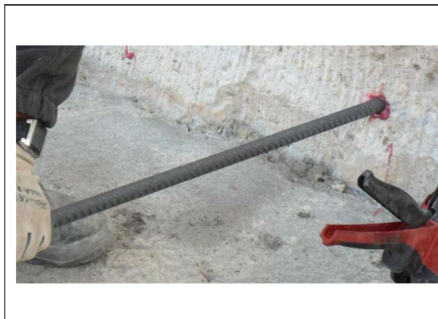
21 de febrero de 2012. Inicio de armado losa 1. Hormigón de limpieza. Inyección de resina epoxi en armaduras de espera.
