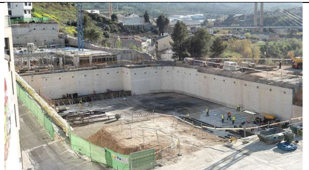
11 de abril de 2012. Encofrado lateral y aislamiento vertical de la junta de dilatación, de la losa en contacto con el terreno, con poliestireno extruido. 60% Encofrado del forjado 3
