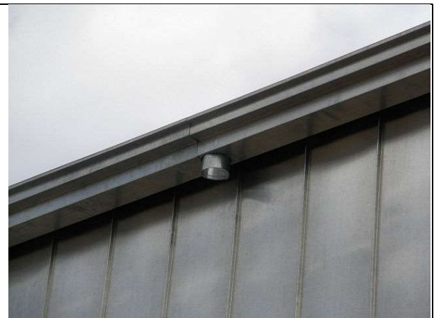
Colocación del canalón de la cubierta de chapa. Se inspeccionan remates de voladizos y encuentros de la fachada con la cubierta.
