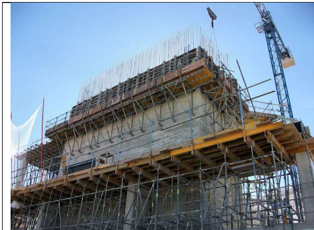
17 de octubre de 2012. Detalle del encofrado trepante visto desde el interior del pabellón.
