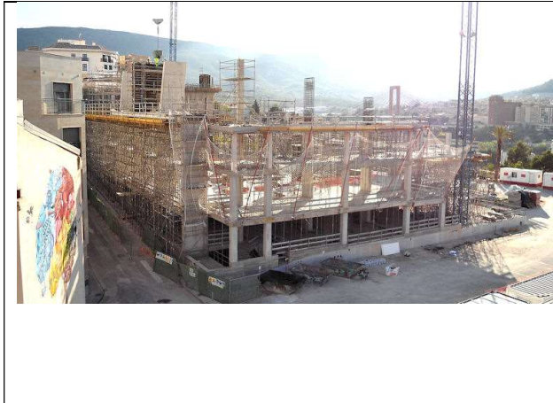
11 de octubre de 2012. Armado de la última planta de pilares de apoyo de la estructura de madera.
