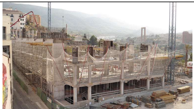
21 de septiembre de 2012. Bloque 1: Cimbra de apoyo de losas y zunchos de arriostamiento de los soportes de la cubierta en el nivel de encofrado 5º.
