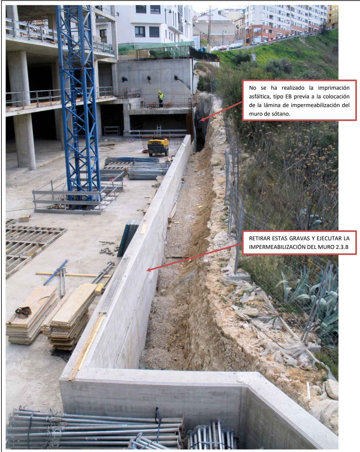
Nº 13. Muro de sótano sin impermeabilizar.
