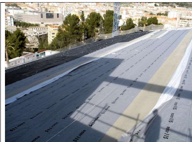
Ejecución de aislamiento e impermeabilización de la cubierta curva del pabellón polideportivo.
