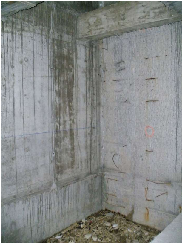
Aljibe Planta sótano -3. Armaduras del muro pantalla descubiertas.
