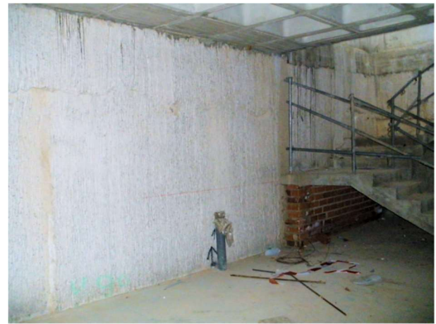
Ausencia de junta de pavimento en encuentro con muros y tabiques.
