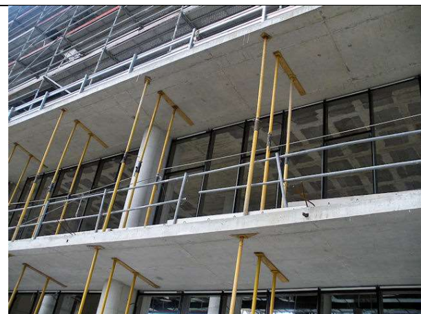
BLOQUE 1. Fachada OESTE 18 . Colocación carpintería de aluminio en plantas 1ª y 2ª
