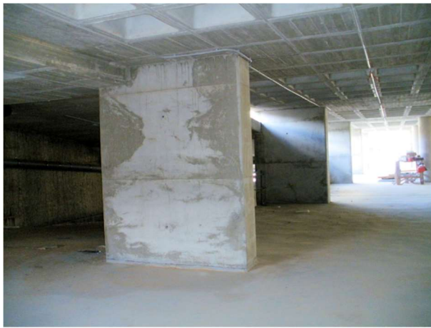
Ausencia de junta de pavimento alrededor de pilares
