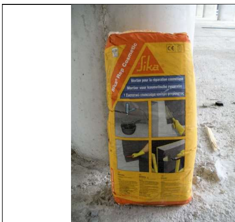
Mortero de reparación estructural. Comprobación del material. Almacenamiento incorrecto.
