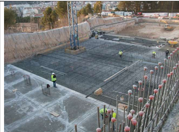
1 de marzo de 2013. Corte juntas de retracción de losa 1 y final de armado.
