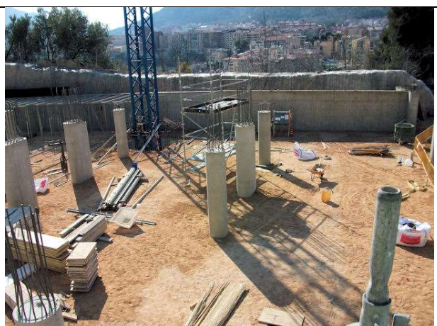
29 de marzo de 2012. Últimos bataches de muro de sótano de la fachada oeste en planta de garajes -1. HA-30/B/12/IIa+Qa
