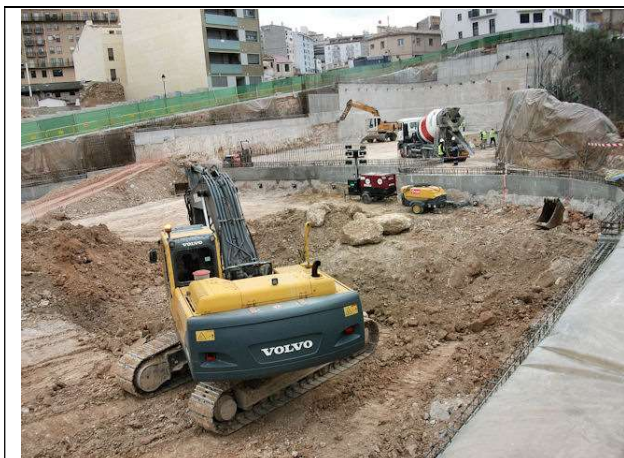
20 de febrero de 2012. Bloque 1: Vertido desde camión de capa de hormigón de limpieza HL-150/B/20, fabricado en central, de 10 cm de espesor.
