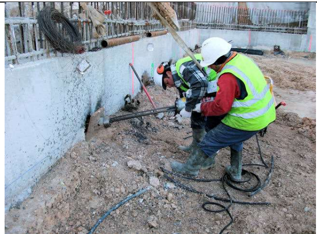
30 de enero de 2012. Tesado de anclajes provisionales de las pantallas de contención de la fachada este. (C/ Alarcón)
