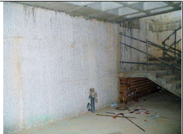
No se han ejecutado las juntas de dilatación del pavimento de las plantas de garaje.
