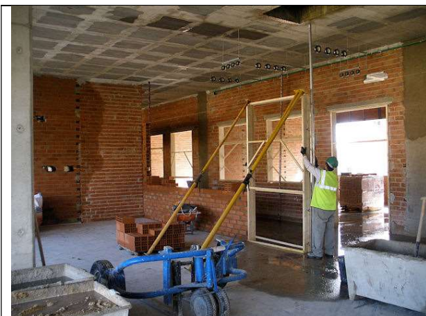
Tabiques de la planta 3ª de ladrillo cerámico hueco doble de 12 cm de espesor. Humedades provocadas por la lluvia.
