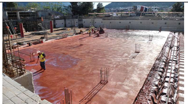
24 de mayo de 2012. Fase 2ª: Extendido y fratasado del mortero de rodadura con áridos de cuarzo y aplicación del líquido de curado.
