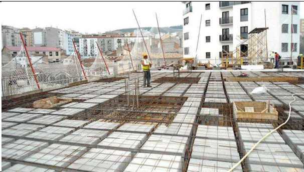
5 de octubre de 2012. Detalle del armado del forjado 6º en dirección sur
