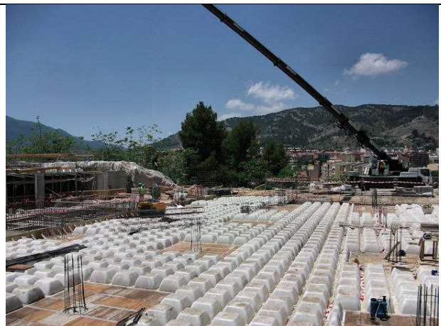
5 de junio de 2012. Bloque 1: Forjado 3º y pilares de planta baja Bloque 2: Forjado 2º de planta garaje -1
