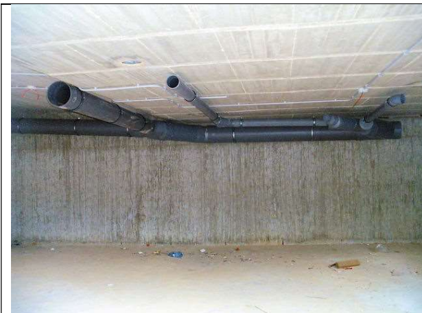
Colocación de conducciones de la red de desagüe de aguas pluviales en sótano-1
