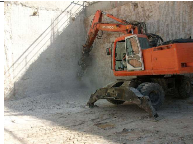
15 de marzo de 2012. Bloque 2: Continúan los trabajos de perfilado de las paredes del muro pantalla en sótano -2.
