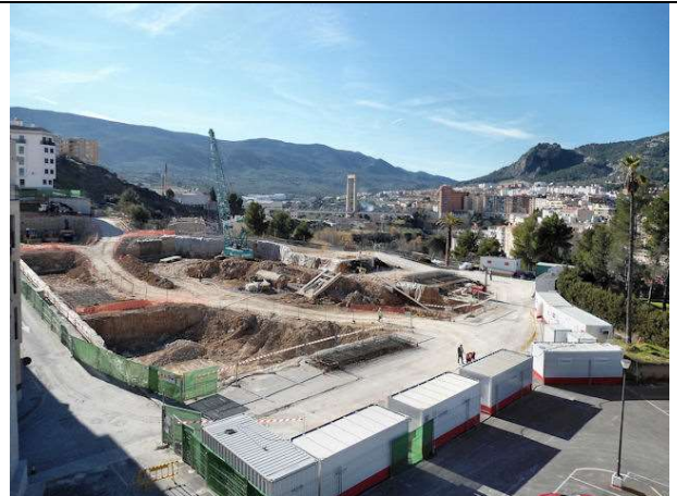
4 de enero de 2012. Última fase de bataches de muro pantalla en el lado este del pabellón. (Bloque 2)
