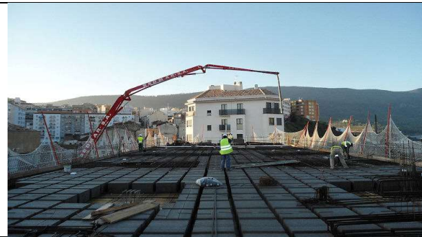
16 de noviembre de 2012. Bloque 1, PAC: Hormigonado forjado 7º, Terraza ubicación equipos de instalaciones.
