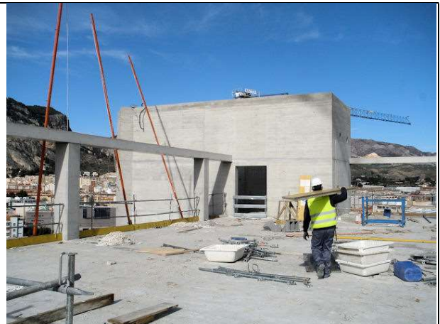
Comprobaciones de la coronación de las pantallas del núcleo de escalera y ascensores.
