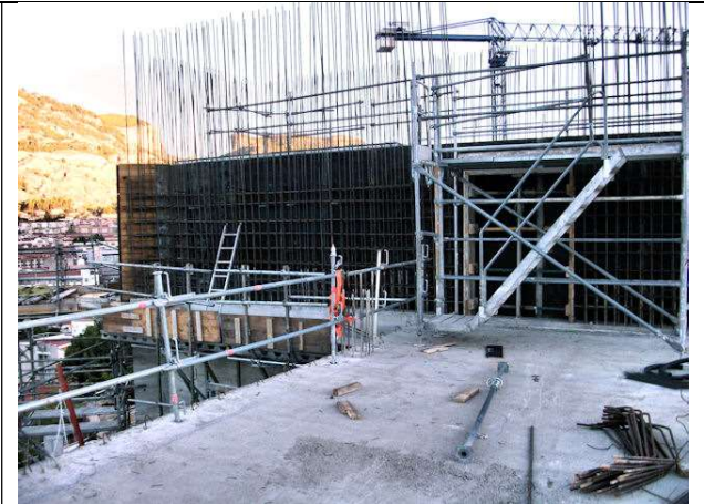
17 de octubre de 2012. Armado del muro del núcleo de escalera para apoyo del forjado 7º de cubierta (PAC).
