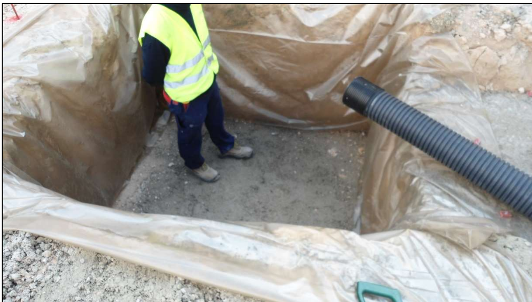
Ilustración 12. Arqueta de paso alojada en losa sótano -3. Fotografía del 3 de abril de 2012.
