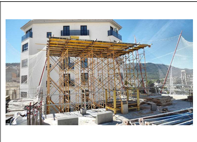
17 de octubre de 2012. Bloque 1: Cimbra soporte de la marquesina que cubre la entrada sur a la sección de despachos y laboratorios
