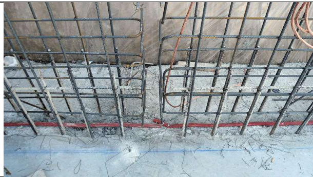
7 de marzo de 2012. 4 Armado muros de fachada oeste bloque 1. Colocación de junta hidroexpansiva de bentonita.
