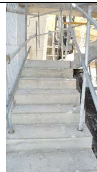
23 de noviembre de 2012. Bloque 2. Escalera 6. Disposición de barandillas de protección. Falta colocar el rodapié y red vertical.
