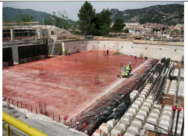
18 de mayo de 2012. Bloque 2, pavimento garaje -2: Extendido y fratasado mortero de rodadura coloreado rojo.
