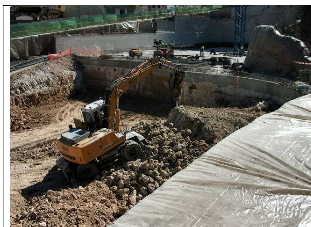
24 de febrero de 2012. Imprevisto. Rocas compactas / blandas no caracterizadas en el estudio geotécnico. Requiere de martillo rompedor.
