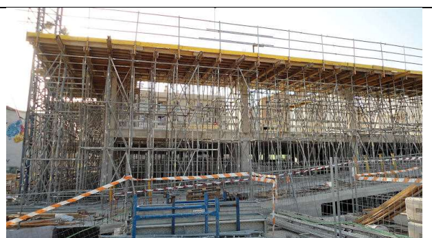
22 de agosto de 2012. Bloque 2: Nivel Forjado 4º: Cimbra de base de encofrado de losas y zunchos de atado perimetral alrededor del pabellón.
