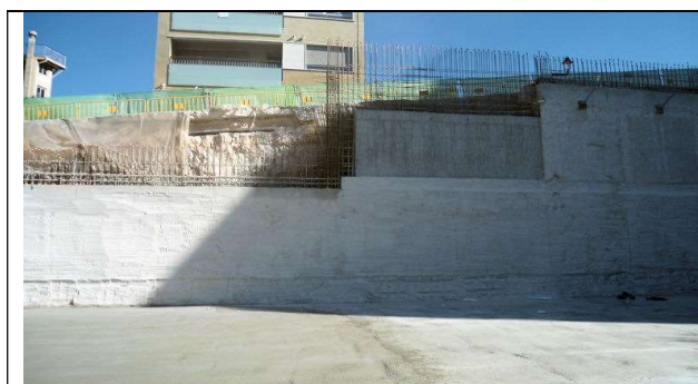
23 de febrero de 2012. Finaliza el vertido del hormigón de limpieza de la losa 1 del edificio nuevo.
