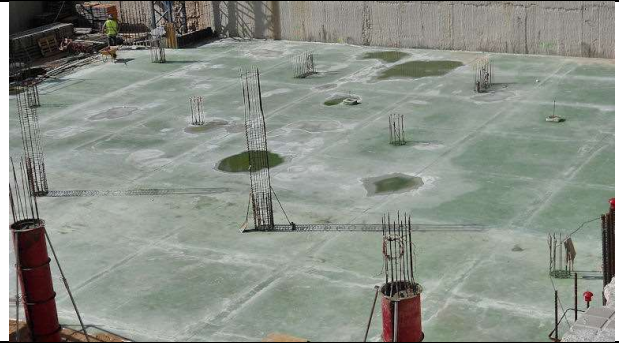
2 de mayo de 2012. Bloq. 2, sótano -3: Curado de la capa de rodadura y corte de juntas de retracción sobre la losa 2.
