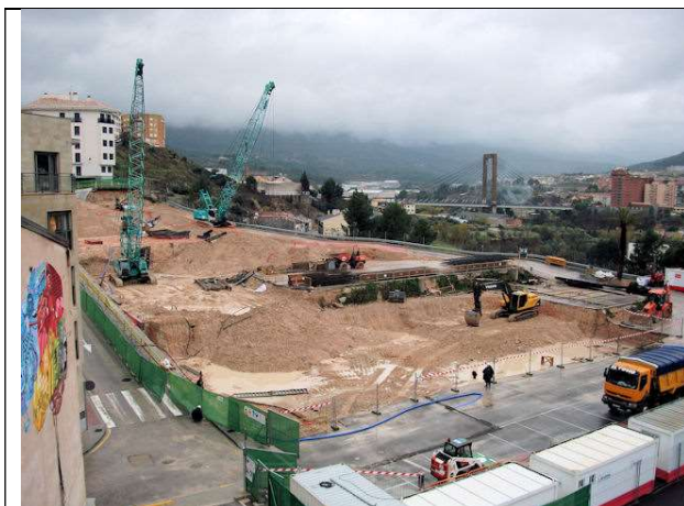
23 de noviembre de 2011. Ampliación de zonas de trabajo. Zona sur muros pantalla; norte, escalonado y nivelación de tierras.
