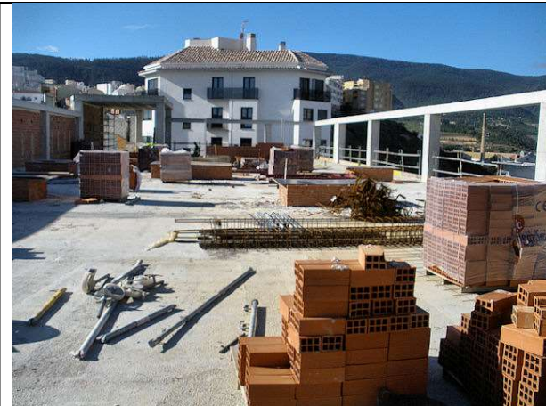
BLOQUE 1: Debería ser prioritario acabar los trabajos de albañilería para la impermeabilización.
