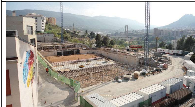
18 de mayo de 2012. Bloque 2: Protección de la capa de rodadura mediante lona de plástico y arena
