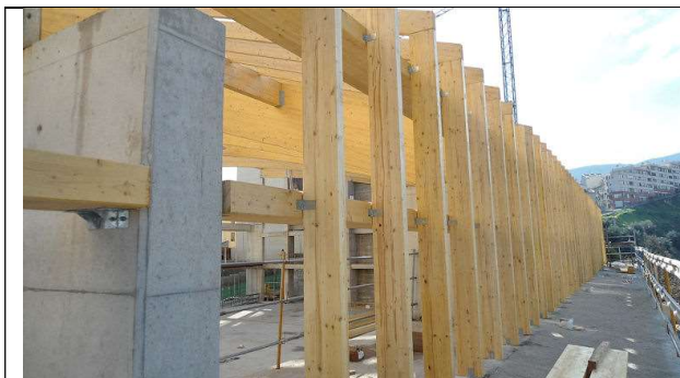
23 de noviembre de 2012. Bloque 2: Detalle de la disposición de correas y cabios en la fachada OESTE.
