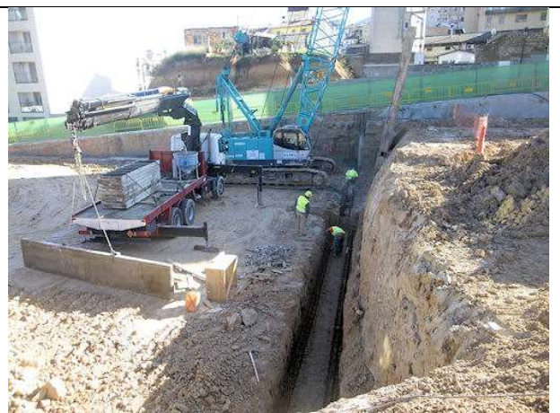
1 de diciembre de 2011. Encofrado y armado del murete guía transversal que limita con el núcleo central de escaleras y ascensores.
