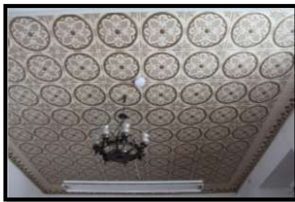
Gráfico 24 Cielo raso metálico. Fuente: GAD Ayuntamiento de Ambato
