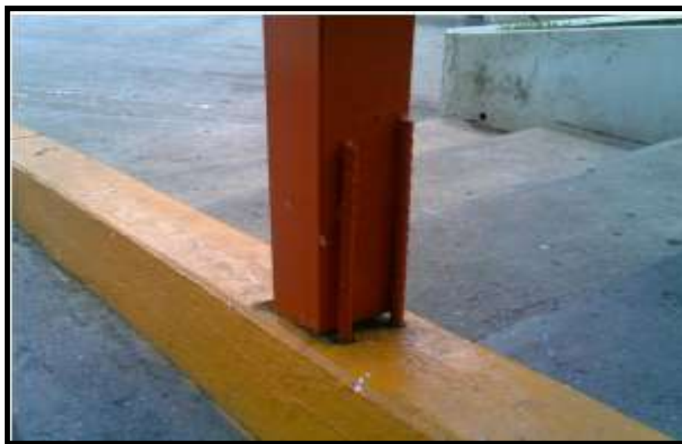
Gráfico 2 Deficiente unión del elemento metálico con el suelo. Fuente: Ayuntamiento de Ambato
