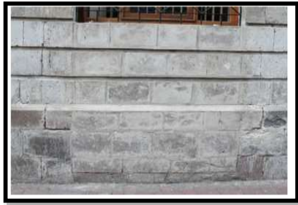
Gráfico 20 Detalle del antepecho añadido en planta baja, cerrando los vanos. Fuente: GAD Ayuntamiento de Ambato
