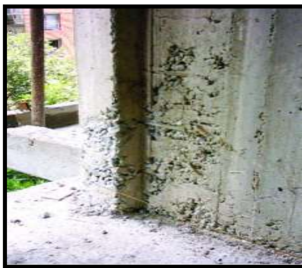
Gráfico 3 Mala distribución de los compuestos del concreto, manifestación típica de un vibrado insuficiente. Fuente: Ayuntamiento de Ambato
