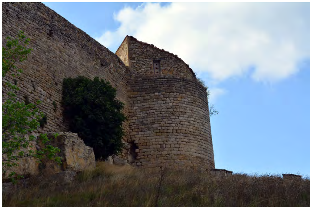
FIGURA 133. Vista de la Torre Redona des de l'exterior de les muralles, abans de la intervenció (Ajuntament de Morella, 2018).
