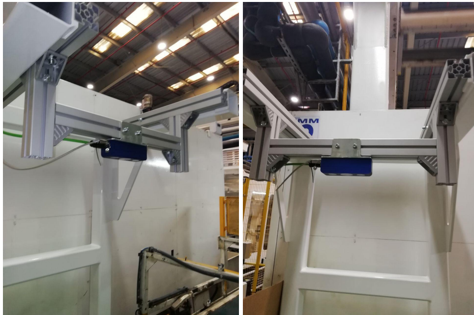
Figura 32: Estación ST15 en puesta en marcha
