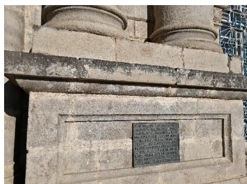
Ilustración 119. Patología en cornisa, 2019 Fuente: autor, Calle G., 2019
