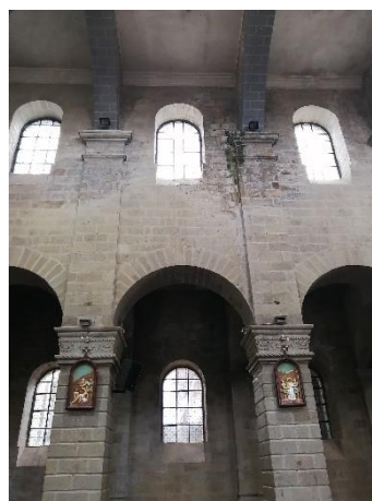
Ilustración 117. Humedades existentes Fuente: autor, Calle G., 2019
