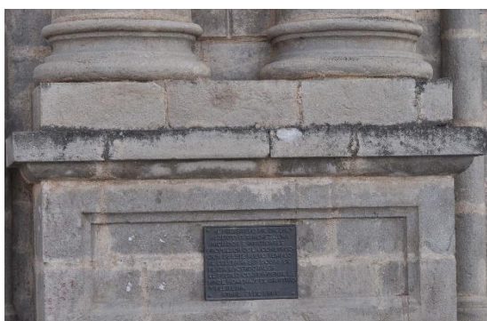
Ilustración 118. Patología en cornisa, 2014 Fuente: GAD Municipal de Azogues
