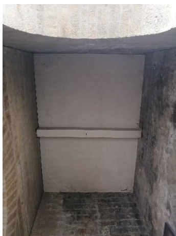
Ilustración 116. Humedades existentes Fuente: autor, Calle G., 2019
