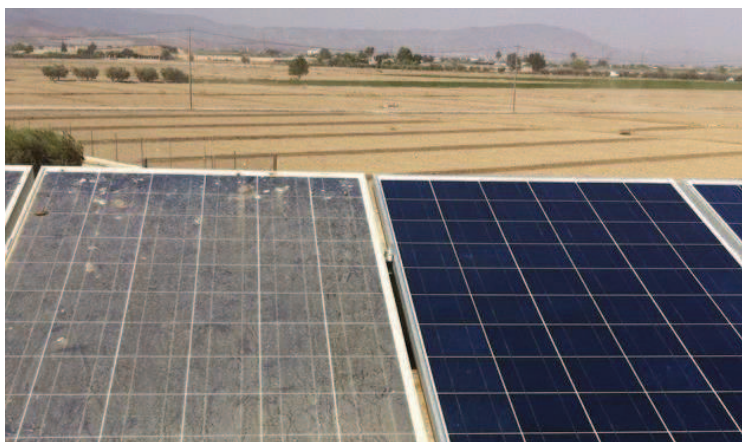
Ilustración 26 – Comparativa entre un panel limpio y otro notablemente sucio
