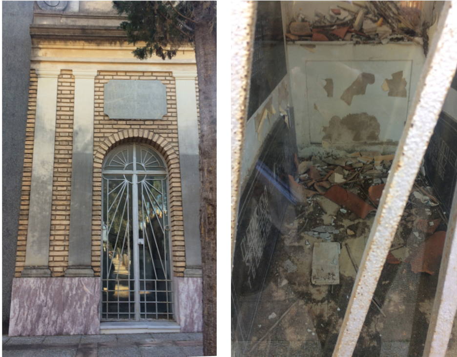
Figura 78: Mausoleo inventariado con estado de conservación muy malo.
