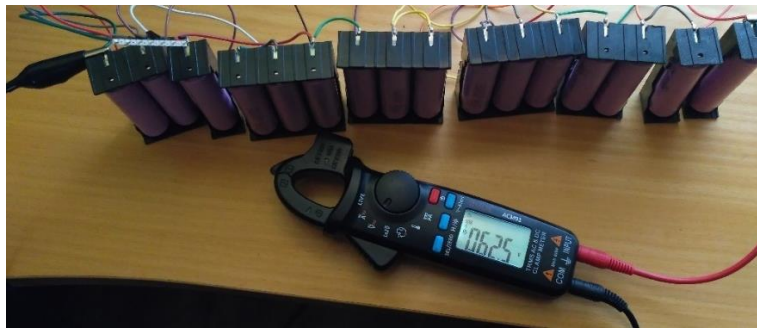
Figura 61. Medición de tensión en bornes del pack de baterías. 62,5 V
