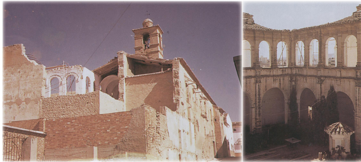
Obras de reforma del convento en 1979, se desplomaron parte de los claustros.
