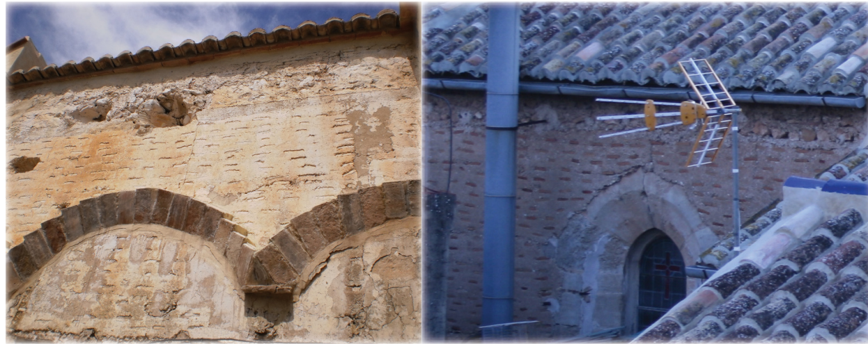
Fábrica combinada con tapia valenciana y mampostería ordinaria en la pared lateral derecha y en la pared lateral izquierda.
