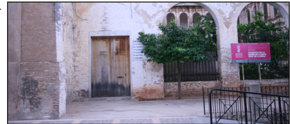
Acceso a la antigua bodega, desde la avda San Francisco de Borja.
