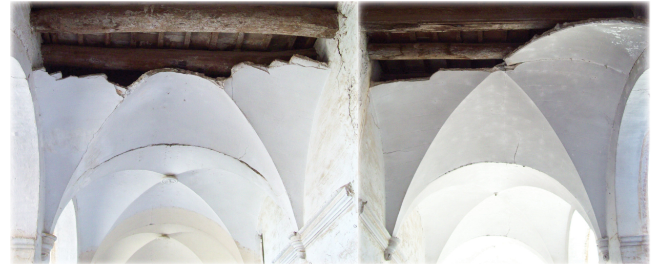
Tramo de bóveda de rincón de claustro donde se puede ver el forjado.
