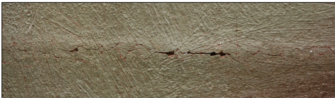
Fig. 20. Detalle de grieta filiforme siguiendo la dirección de la costura
