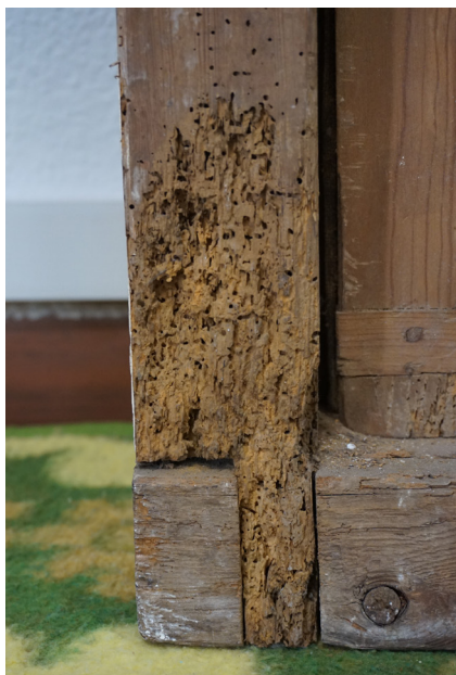
Fig. 48. Detalle del deterioro en el marco provocado por el Anobium Punctatum .
