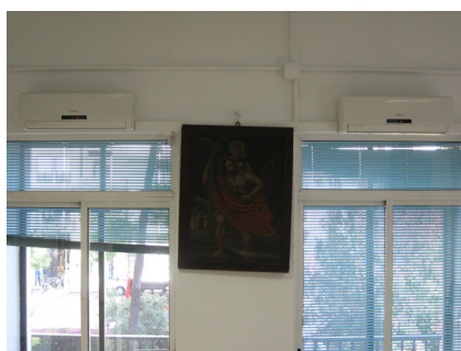
Fig. 23. Vista de las máquinas de aire acondicionado, ubicadas en la pared Este.
