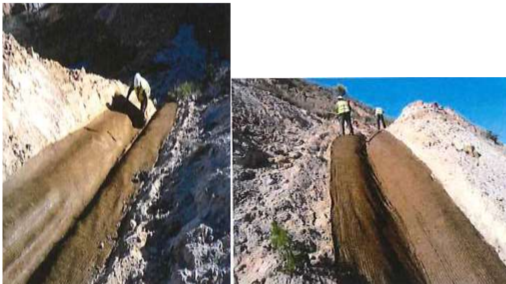
Figura nº16. Fotografía del revestimiento en bajantes.
